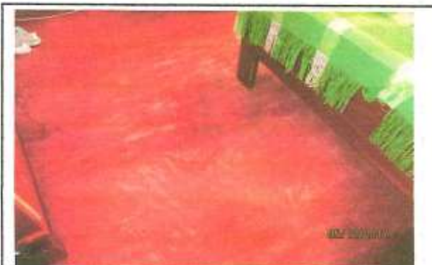
Piso habitación 1, se encuentra en similares condiciones a las encontradas el día 20 de diciembre de 2016 y registradas en el acta 015.
