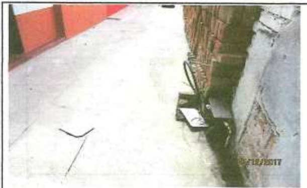
Patio exterior se encuentra en similares condiciones a las encontradas el día 20 de diciembre de 2016 y registradas en el acta 015.
