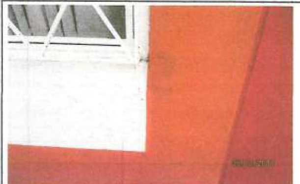
Fisura diagonal en fachada se encuentra en similares condiciones a las encontradas el día 20 de diciembre de 2016 y registradas en el acta 015.
