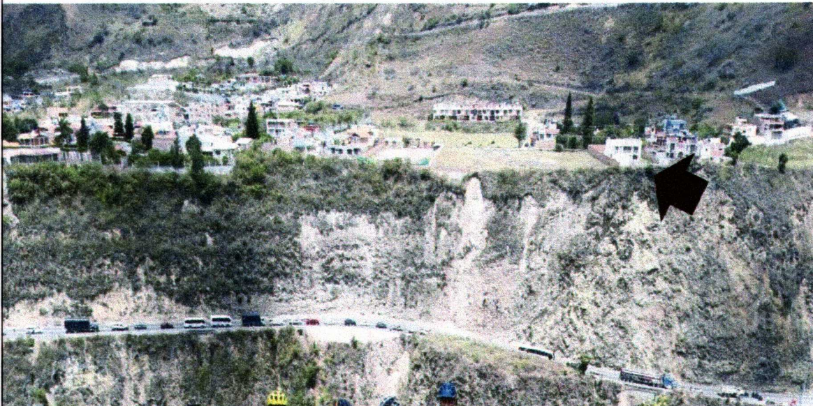
AL REALIZAR EL CORTE DEL TALUD LA VIVIENDA QUEDARIA A 2.00 METROS DEL ABISMO.
