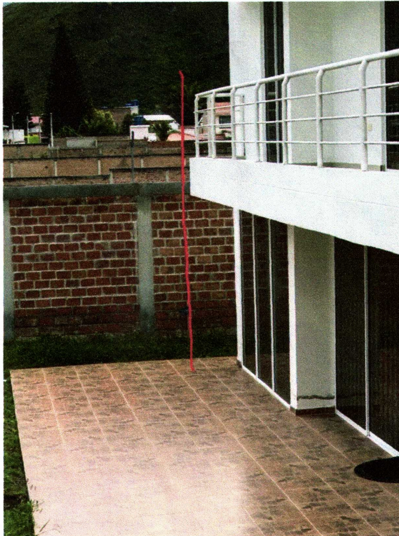
FACHADA PRINCIPAL DEL PREDIO Y SITIO DONDE SE LOCALIZARIA EL MURO DE CERRAMIENTO
