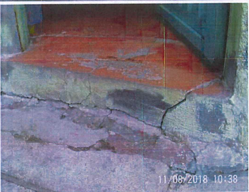
Ingreso a la habitación del costado izquierdo desde la zona del lavadero, agrietado y fisurado.
