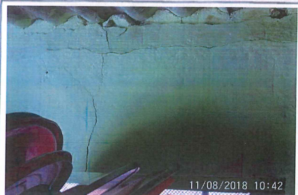
Pared del costado izquierdo de la cocina, agrietamiento tanto transversal o longitudinal.
