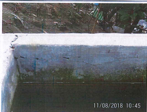
Detalle de la pared posterior del lavadero, fisuramiento en la parte superior.
