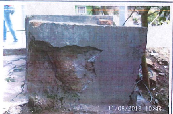
Lavadero, construido en tapia con desprendimiento de material en la pared lateral derecha.
