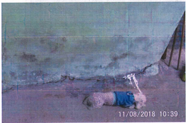
Muro de la zona posterior, con agrietamiento en la zona inferior.
