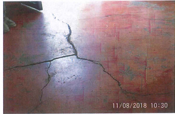
Piso en mineral rojo agrietado, en la habitación ubicada del costado izquierdo.
