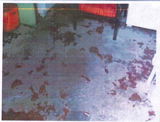
Piso de la cocina, en mineral rojo en mal estado, con evidente desgaste y desprendimiento de material.
