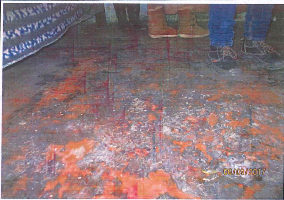
Losa de piso en concreto, con acabado en mineral, presencia de fisuras y desgaste superficial
