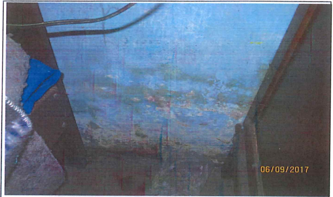
Presencia de humedad en la parte inferior de los muros laterales de la habitación número 01 de la vivienda
