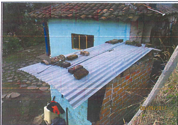
Cubierta de baño en teja de zinc, se observa con abolladuras y sin amarres, técnicamente no adecuada
