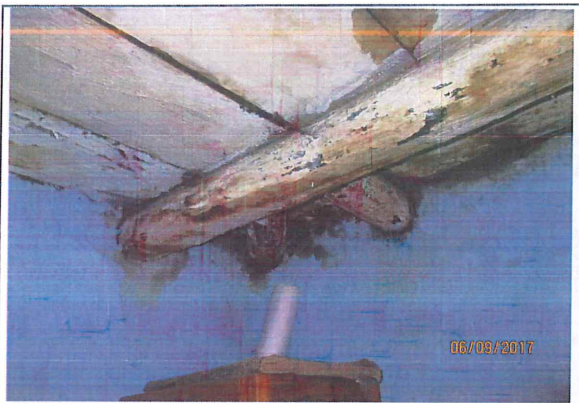
Presencia de humedad y deterioro sobre el soporte de madera y cielo raso de la cubierta, filtración de agua en la habitación número 01 de la vivienda
