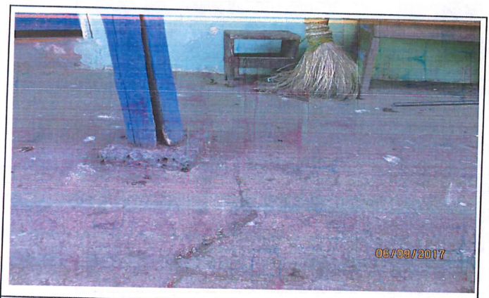
Presencia de fisuras transversales en la losa del piso, patio de acceso a habitaciones de la vivienda, postes de soporte de cubierta en zona frontal en mal estado
