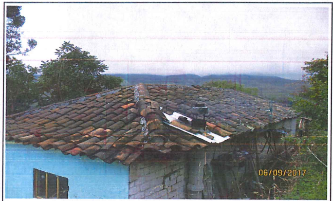
Cubierta de la vivienda en teja de barro, algunas piezas en mal estado y con reparaciones técnicamente no adecuadas, se observa incorrecto manejo, canalización y drenaje de aguas lluvias
