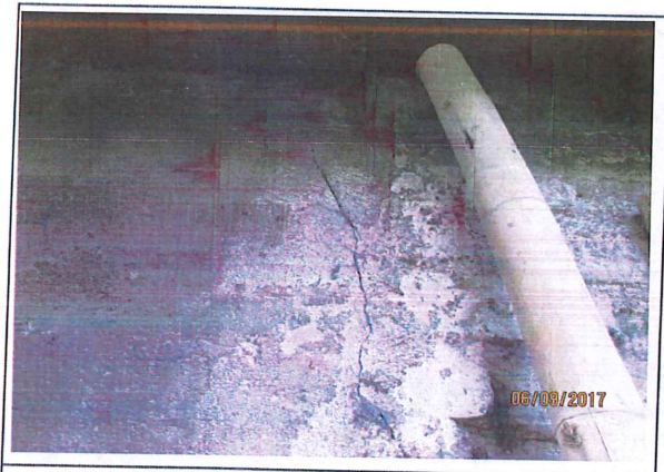
Presencia de fisura verticales en muro posterior de la vivienda, junta entre muros de adobe y de ladrillo macizo
