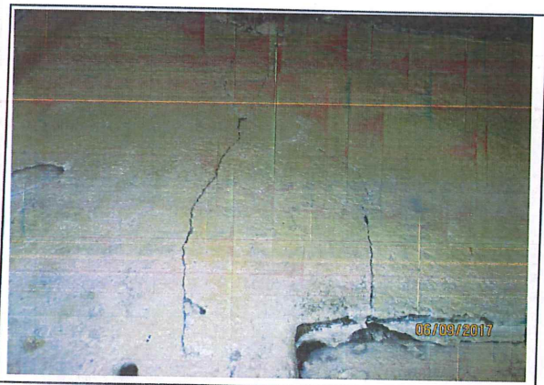
Presencia de fisuras verticales y desprendimiento de repello zona superior de acceso a cocina, muro posterior
