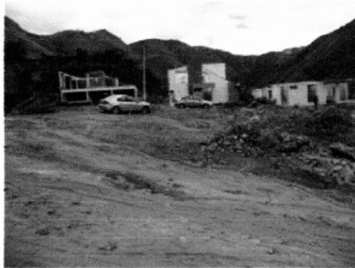
El conjunto esta desprotegido e inseguro
