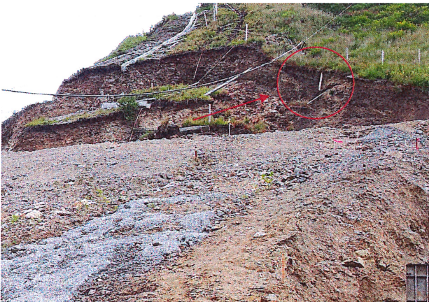
La propietaria indica adicionalmente que en la parte posterior de su predio se presentan deslizamientos debidos a la obras de corte y nos señala un poste en concreto desplomado a causa de esto.
