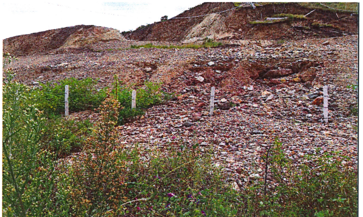
Se evidencia deslizamiento desde el terraplen que colinda con su predio , observamos material arrastrado en el interior de su terreno.
