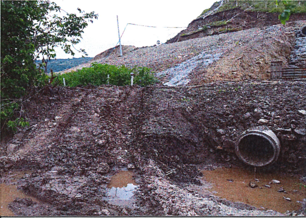
Propietaria manifiesta la construcción del descole de una alcantarilla en su predio, el cual causa afectaciones de socavación y surcos en su terreno.
