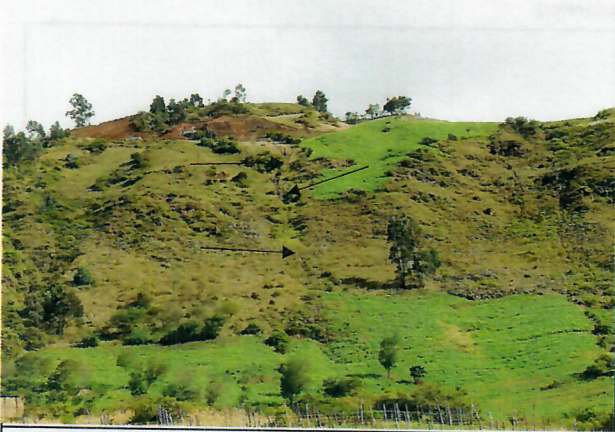
Se observa socavación por escorrentías
