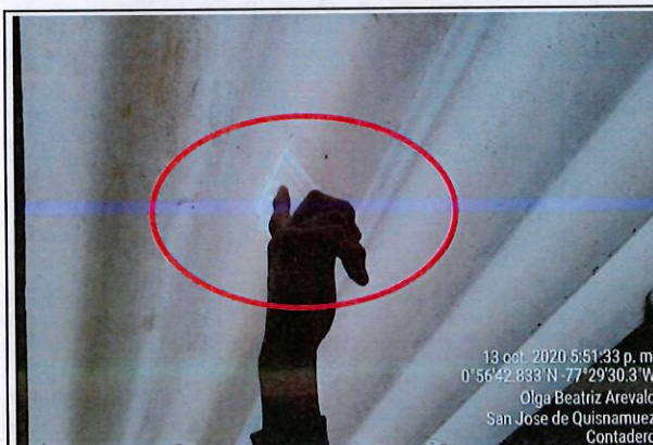
Cubierta en zona de cocina: se observa fractura de teja plástica.
