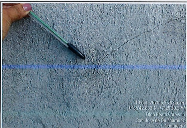
Fachada lateral izquierda: se observan múltiples fisuras longitudinales y transversales de tipo superficial en el repello.
