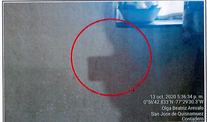
Cocina: se observa fisura en muro lateral derecho, esto es en el borde inferior izquierdo de la ventana, de tipo superficial en los acabados en repello y pintura.
