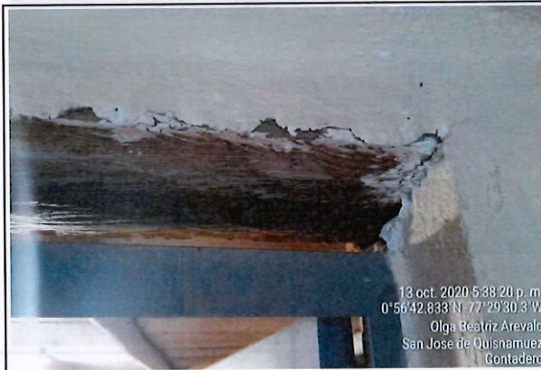
Habitacion 1: se observa desprendimiento de acabados sobre marco puerta esto es en repello y pintura, así como fisuras longitudinales y transversales en muro posterior y lateral izquierdo.
