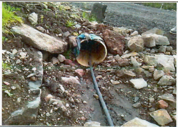
Descole canalizado actualmente, debido al acceso que se le construyo en el predio se instalo tubería PVC corrugada
