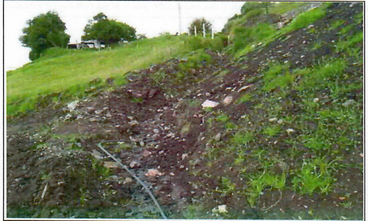
Descole de alcantarilla existente desde la cual en el mes de octubre del 2019 se condujo el agua que presuntamente afecto el terreno
