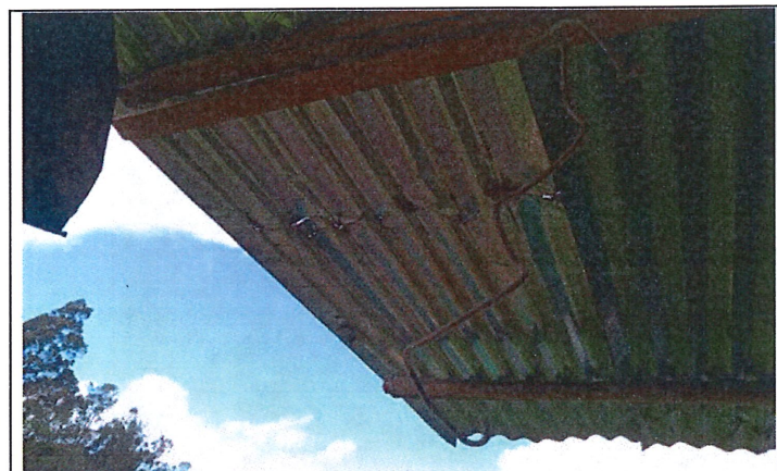
Hoja de zinc con abolladuras, se ubica en patio o área de labores, de acuerdo a lo indicado por propietario se debe a impacto de roca proveniente de voladuras
