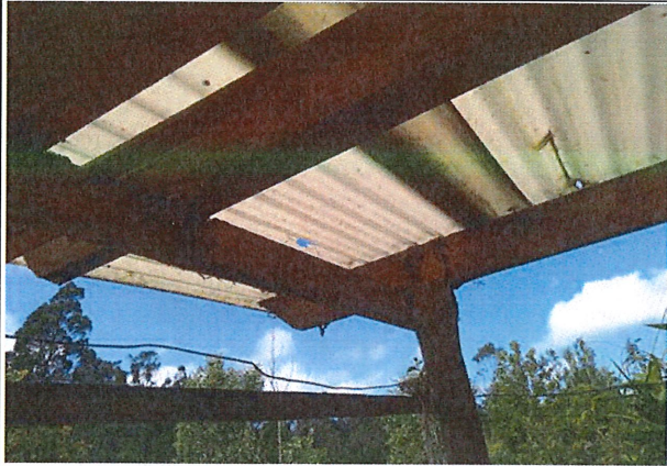
Teja fracturada ubicada en zona de lavado, es tipo PVC, de acuerdo a lo indicado por propietario se debe a impacto de roca proveniente de voladuras
