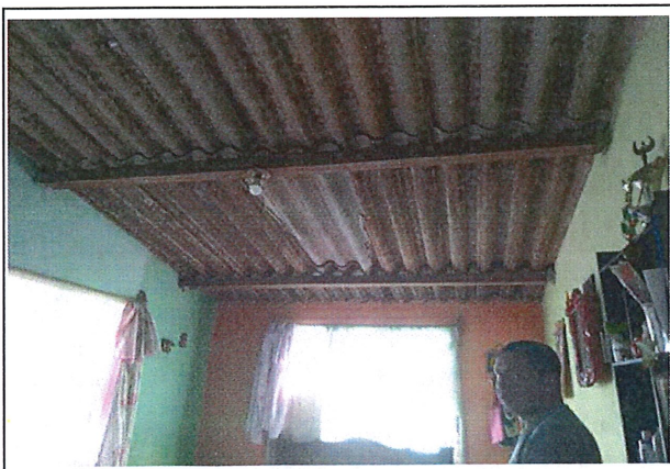
Habitación 1, se observa 5 tejas fracturadas, estas son en fibrocemento, de acuerdo a lo indicado por propietario se debe a impacto de roca proveniente de voladuras
