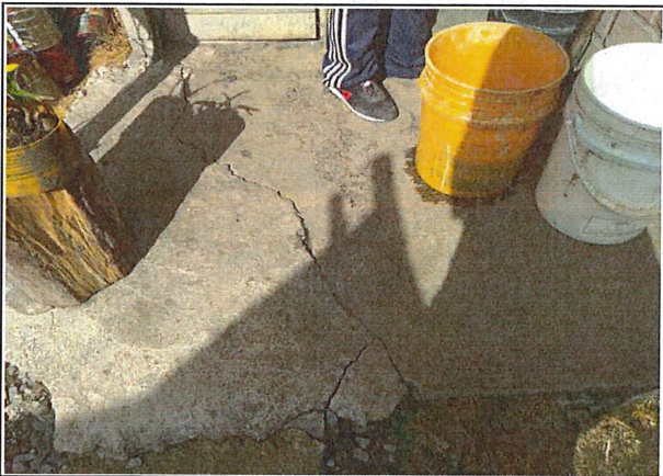
Grietas en piso de zona de lavado, de acuerdo a lo indicado por propietario se debe a vibración de maquinaria que labora por el sector
