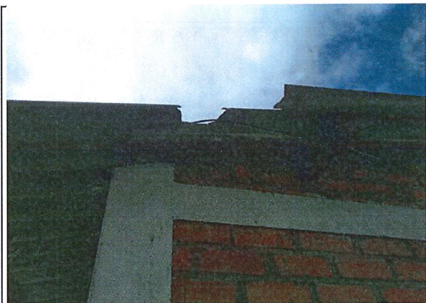
Teja fracturada ubicada en cubierta de vivienda, vista desde fachada frontal (área de voladizo), de acuerdo a lo indicado por propietario se debe a impacto de roca proveniente de voladuras
