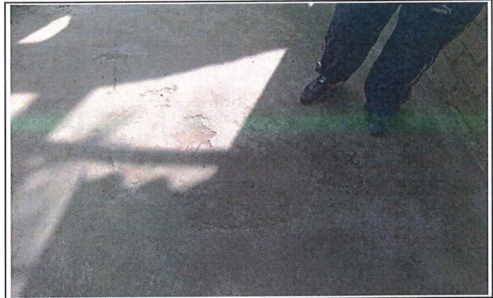
Piso de patio frontal con desprendimiento de material, de acuerdo a lo indicado por propietario se debe a impacto de roca proveniente de voladuras
