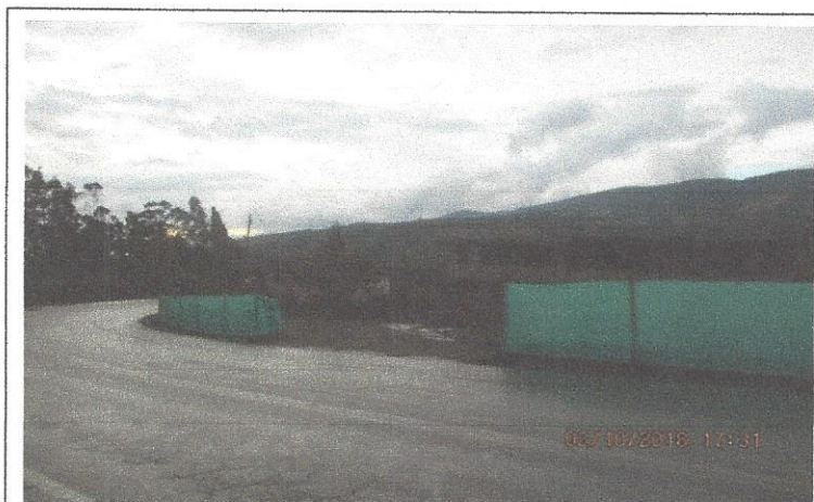
Descripción: Cierre de solicitud GSAU0467-18 con la instalación de polisombra en el predio
