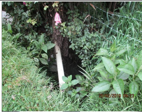
20-02-19. Vereda la Merced. Descole de alcantarillado, ubicado en la zona posterior de la vivienda.
