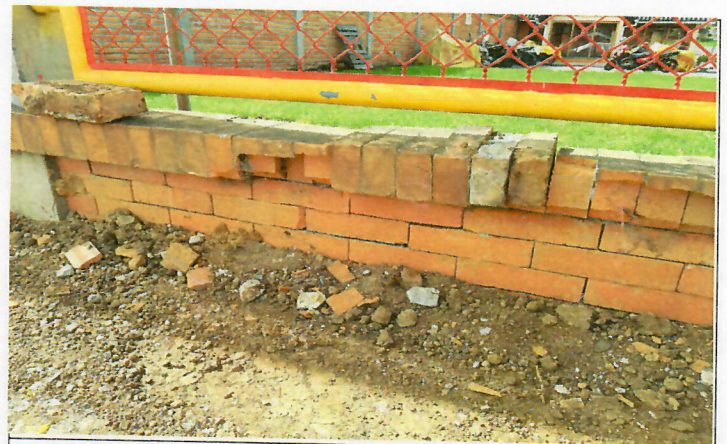
Cara externa, propietario manifiesta desplome parcial del muro de cerramiento debido a un golpe de maquinaria que se encontraba realizando labores a inmediaciones de este.
