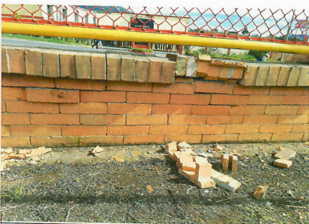
Cara interna, propietario manifiesta desplome parcial del muro de cerramiento debido a un golpe de maquinaria que se encontraba realizando labores a inmediaciones de este.
