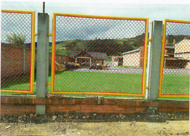
Propietario manifiesta daño al costado izquierdo del cerramiento en el muro ubicado entre la tercera y cuarta columna de confinamiento de izquierda a derecha.
