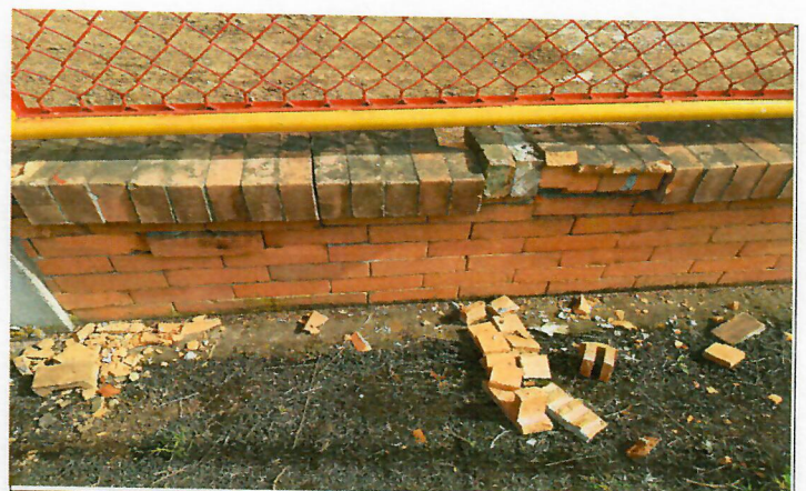
Propietario manifiesta que a pesar del desplome parcial de este muro, se levanto y se sobrepuso la mampostería por temas de seguridad.
