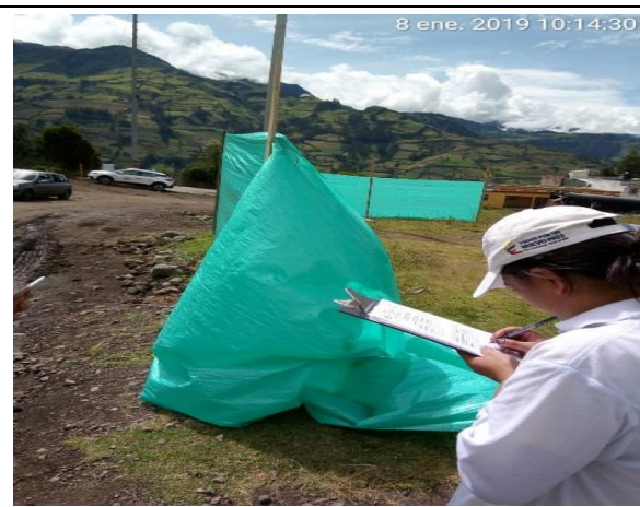
Instalación de polisombra en la vivienda de la peticionaria, ubicada en PR 14+450.
