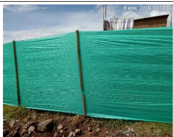
Instalación de polisombra en la vivienda de la peticionaria, ubicada en PR 14+450.
