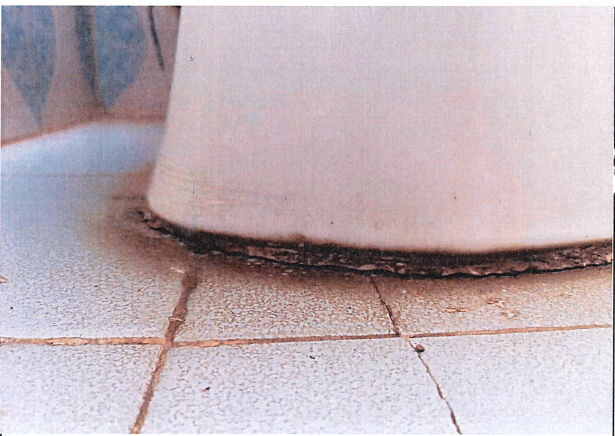
Desprendimiento del inodoro.
