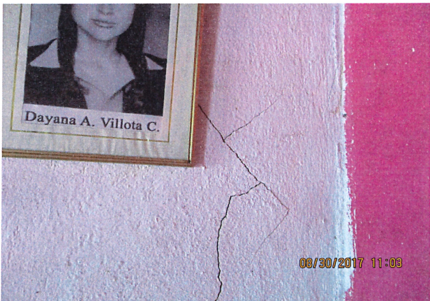
Fotografía acta inicial: Fisura en el muro lateral izquierdo de la sala.
