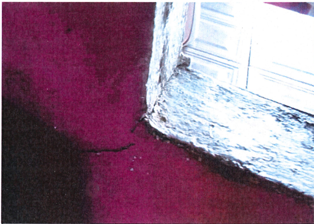
Fotografía acta inicial: Fisura en el muro frontal de la sala.
