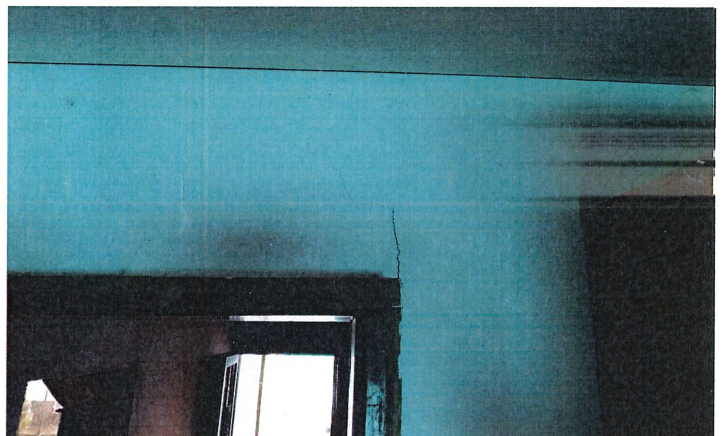
Fisura del muro posterior de la habitación 3, antigua cocina.
