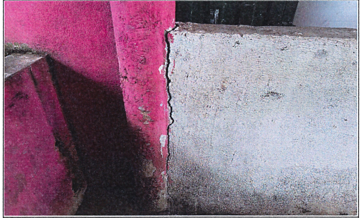
Fotografía acta de seguimiento: Grieta en el muro de la fachada frontal.
