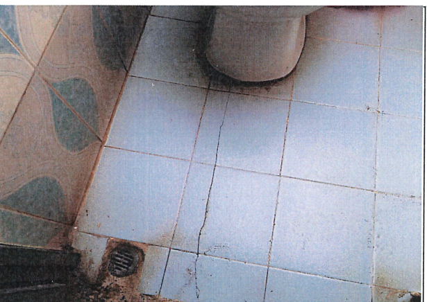
Fisura piso del baño.
