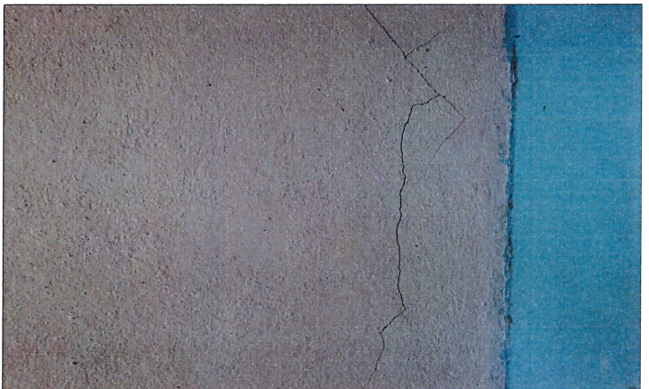
Fotografía acta de seguimiento: Fisura en el muro lateral izquierdo de la sala.
