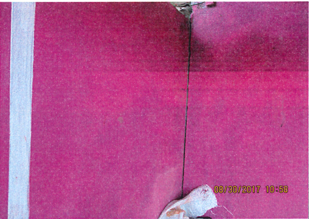
Fotografía acta inicial: Grieta en el muro del baño.
