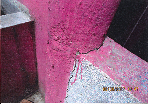
Fotografía acta inicial: Grieta en el muro de la fachada frontal.
