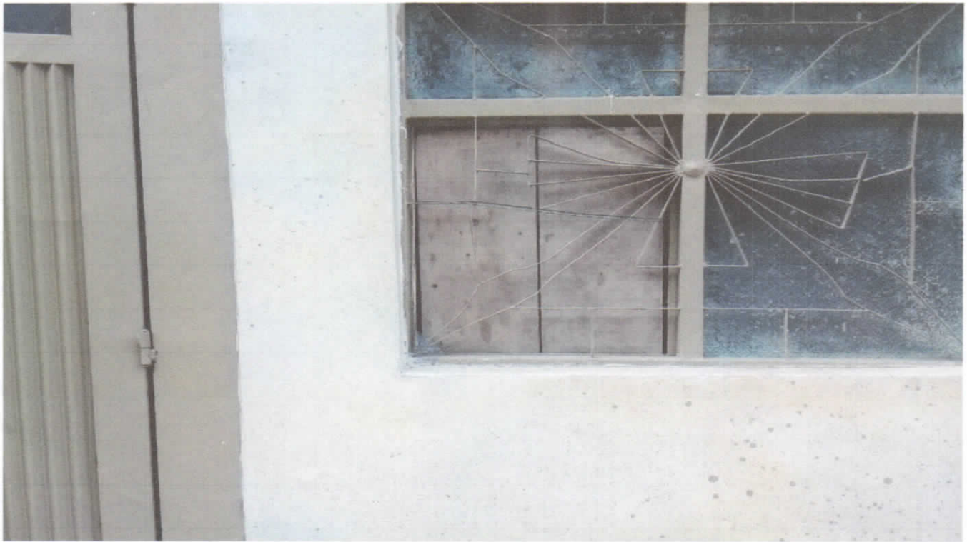
VENTANA CON VIDRIO ROTO
