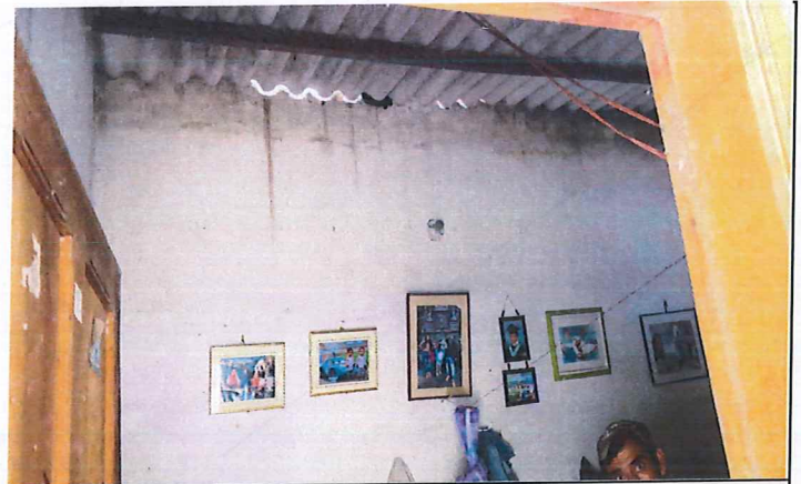
En la estructura 1 o la vivienda se observa el movimiento de varias tejas de fibrocemento ondulado, esto causado aparentemente por las vibraciones de maquinaria pesada.
