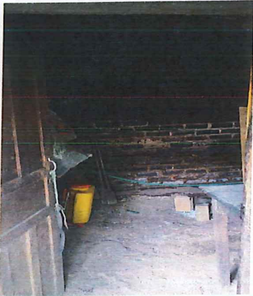
En el interior de la estructura 2, podemos observar un piso en concreto que presenta irregularidades superficiales, desgaste natural y desprendimiento del material.
