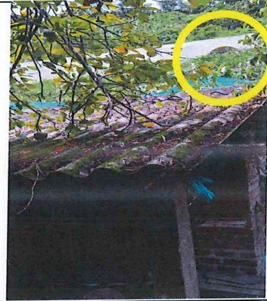
La estructura 2 cuenta con una cubierta en fibrocemento ondulado que presenta deterioro natural. Además, en la imagen se observa la ubicación de la alcantarilla
