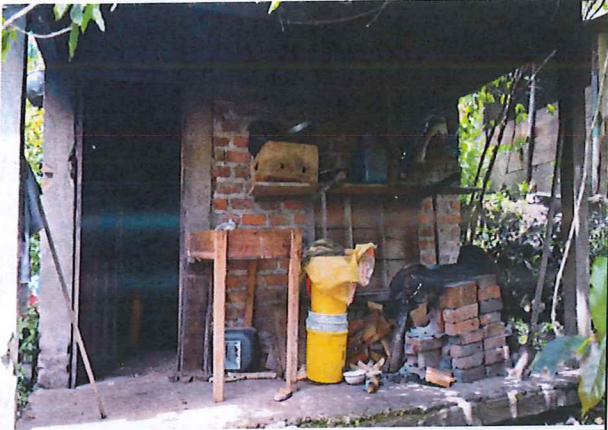
Estado actual de la estructura 2 dedicada para cocina. Se encuentra un espacio de un solo nivel, construido en mampostería de ladrillo con porticos de concreto reforzado.
