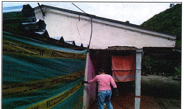
Fachada lateral derecha, se indica grieta y fisuras en muro desde parte superior. De acuerdo al acta inicial estas afectaciones se encontraban desde antes de iniciar actividades constructivas de la doble calzada
