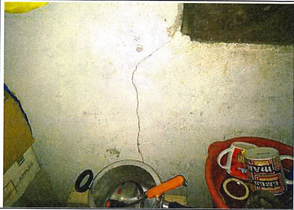
Fisura en muro lateral derecho de cocina 1, de acuerdo al acta inicial esto ha sido un problema existente desde antes de iniciar actividades constructivas
