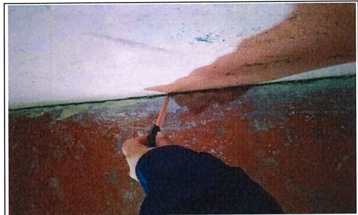
Dilatación o grieta en unión de muro lateral izquierdo y piso en habitación 1
