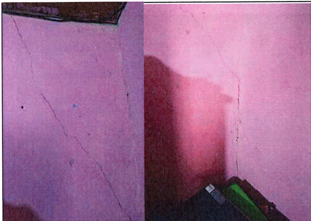
Fisuras en muro frontal y en unión de este con muro lateral derecho de habitación 1, de acuerdo al acta inicial estas no son afectaciones recientes
