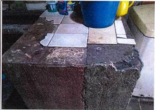
Mesón de cocina de leña con desprendimiento de material, de acuerdo al acta inicial esto ha sido un problema existente desde antes de iniciar actividades constructivas
