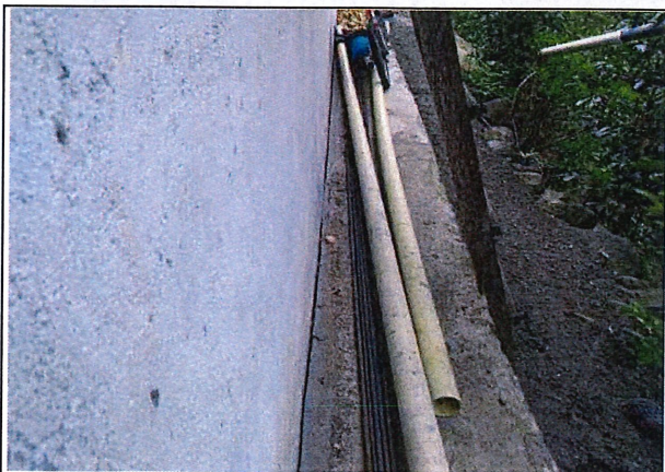
Fachada posterior de la vivienda, se observa dilatación de muro con andén
