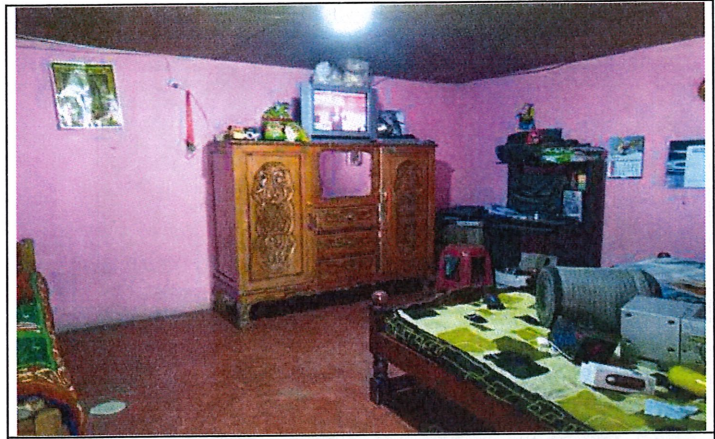
Habitación 1, propietaria manifiesta fisuras y grietas en muros y piso, de acuerdo al acta inicial estas afectaciones se encontraban desde antes de iniciar actividades constructivas para la doble calzada
