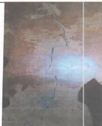
El piso de la habitación 1 se registra con grietas.
