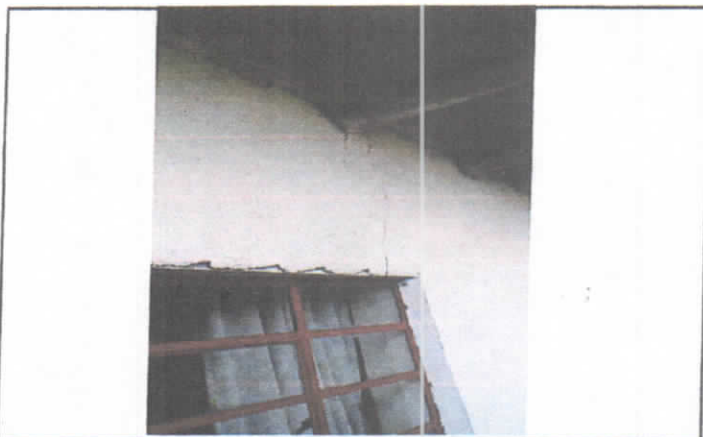
Las siguientes fotografías contienen el registro de las afectaciones mencionadas por la propietaria. Esta se encuentra ubicada cerca de unas de las ventanas de la fachada posterior.
