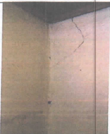
El muro de la habitación 1, también se observa con fisuras.
