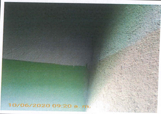
FOTO 3. Pasillo 2, Grieta en muro frontal con muro lateral derecho.
