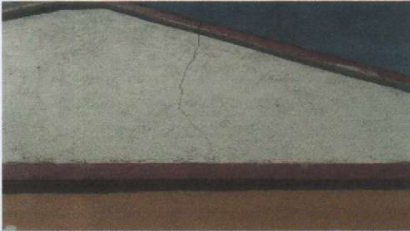
Figura 12. Grieta en Muro Superior. Fuente: Inspección Ocular.
