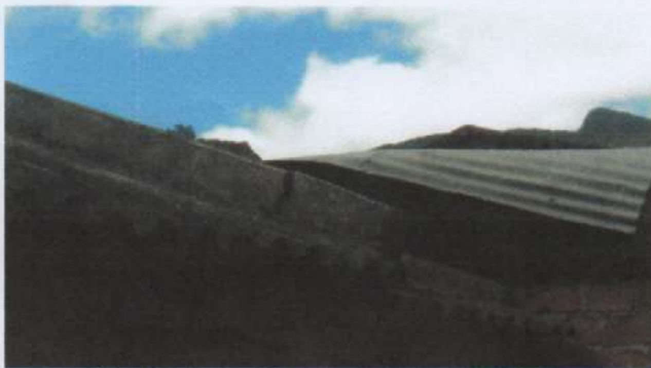
Figura 20. Fractura de Protección Superior de Cubierta. Fuente: Inspección Ocular.
