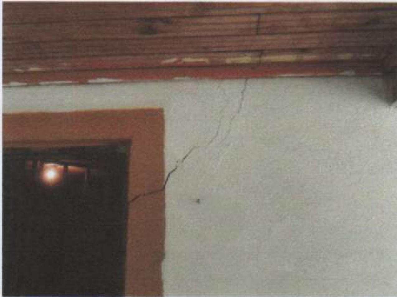
Figura 14. Fractura en Muro Transversal. Fuente: Inspección Ocular.
