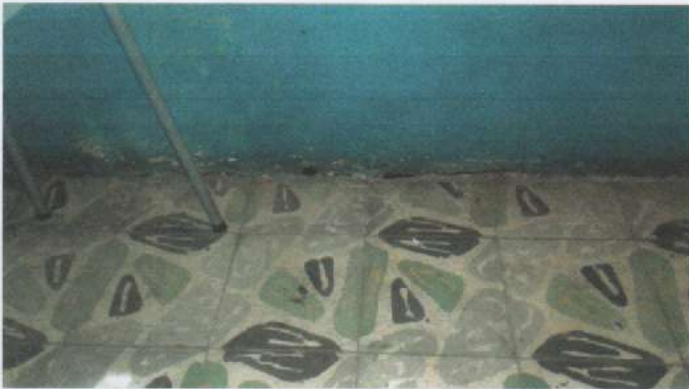
Figura 4. Grieta entre Placa de Piso y Cara Interior de Muro. Fuente: Inspección Ocular.
