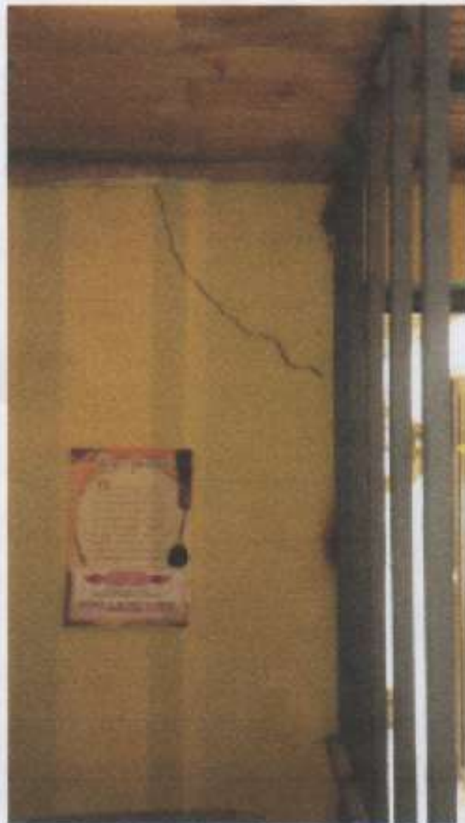
Figura 13. Fractura en Muro Transversal. Fuente: Inspección Ocular
