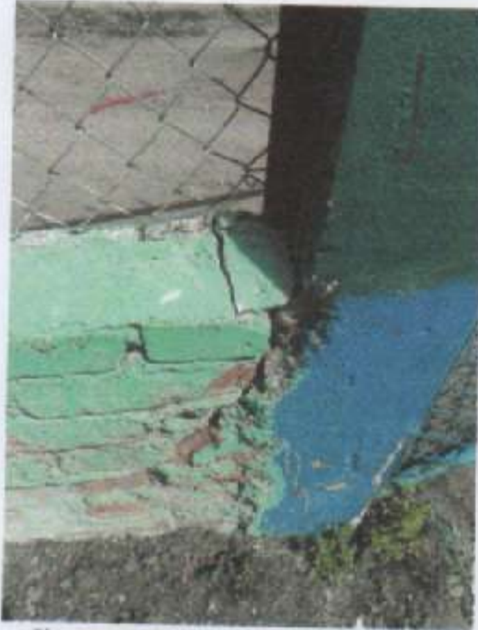
Figura 22. Separación de Elementos en Cerramiento de Lote. Fuente: Inspección Ocular.
