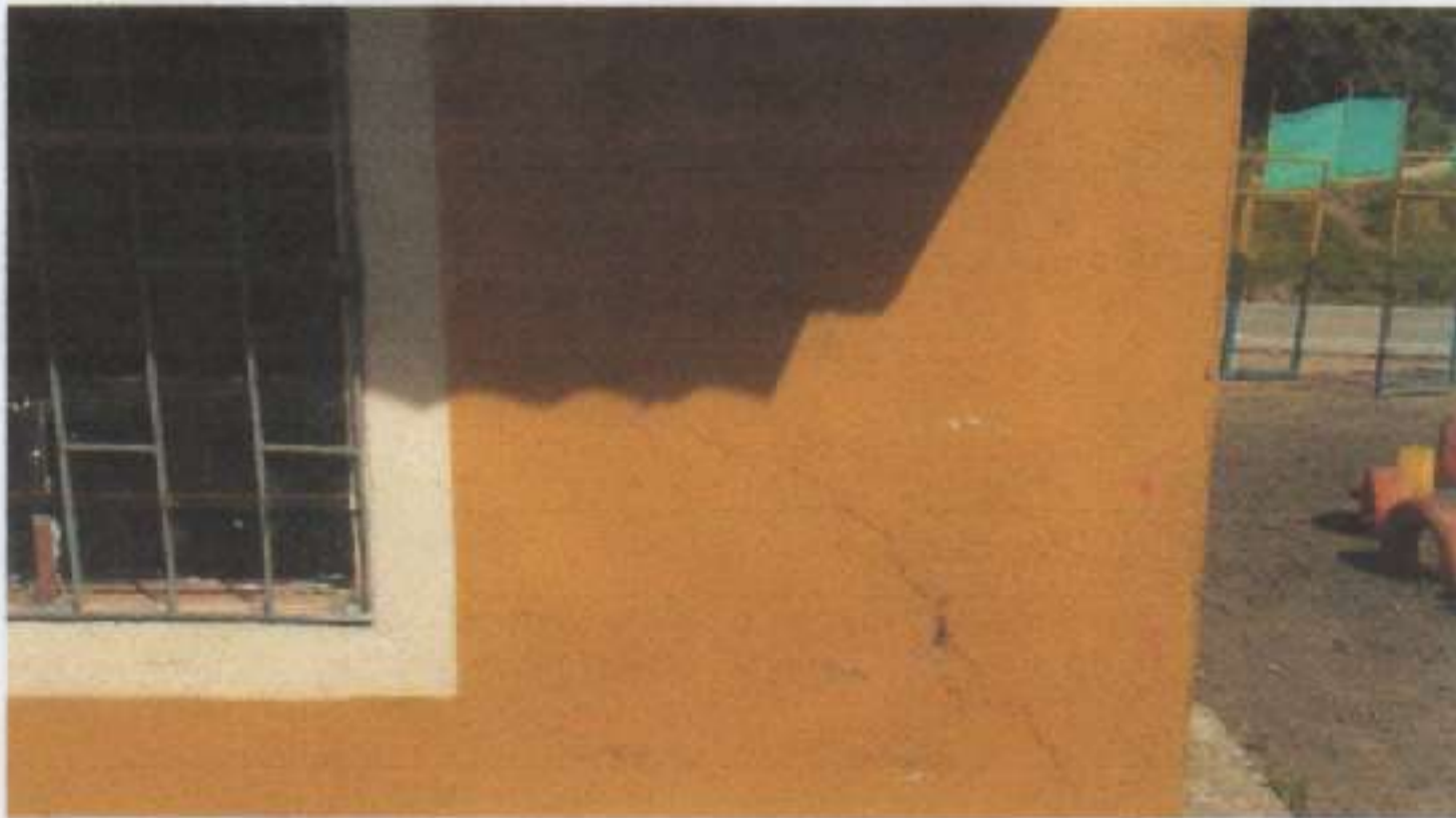
Figura 10. Fractura en Muro Posterior. Fuente: Inspección Ocular.
