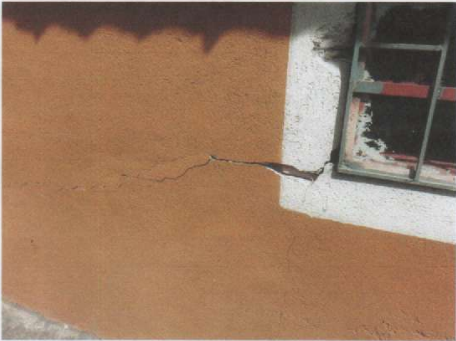
Figura 9. Fractura en Muro Posterior. Fuente: Inspección Ocular.
