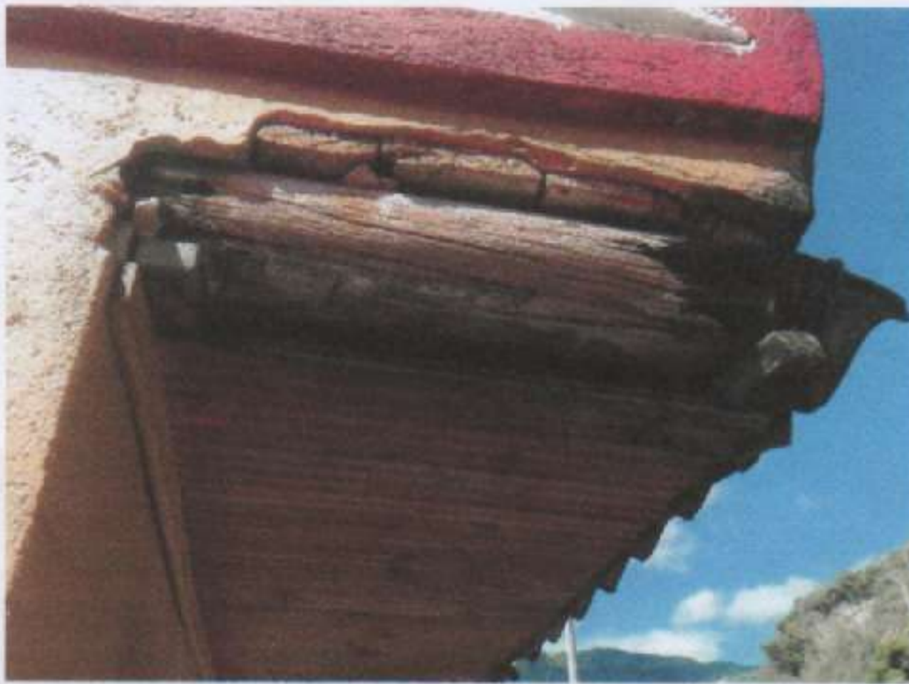
Figura 19. Afectación de Estructura de Cubierta y Cielo Raso. Fuente: Inspección Ocular.
