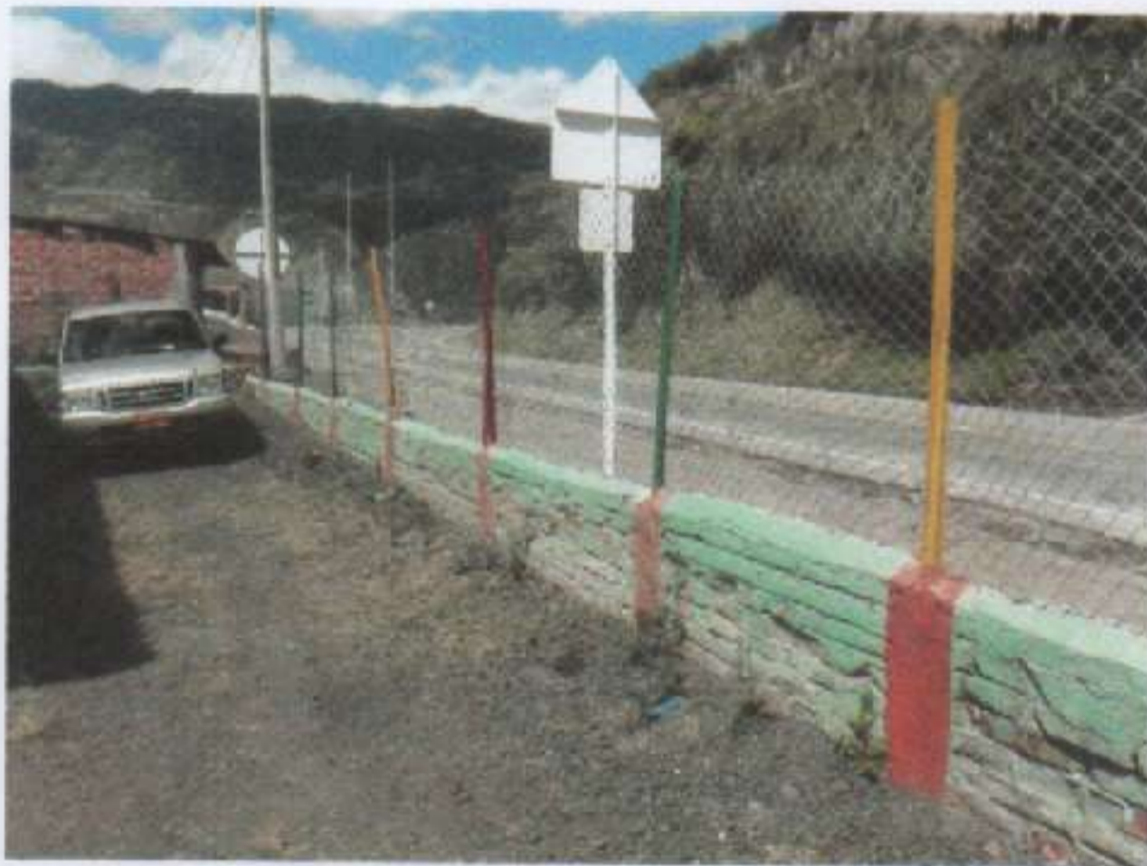
Figura 21. Afectación de Cerramiento por Erosión de Muros. Fuente: Inspección Ocular.
