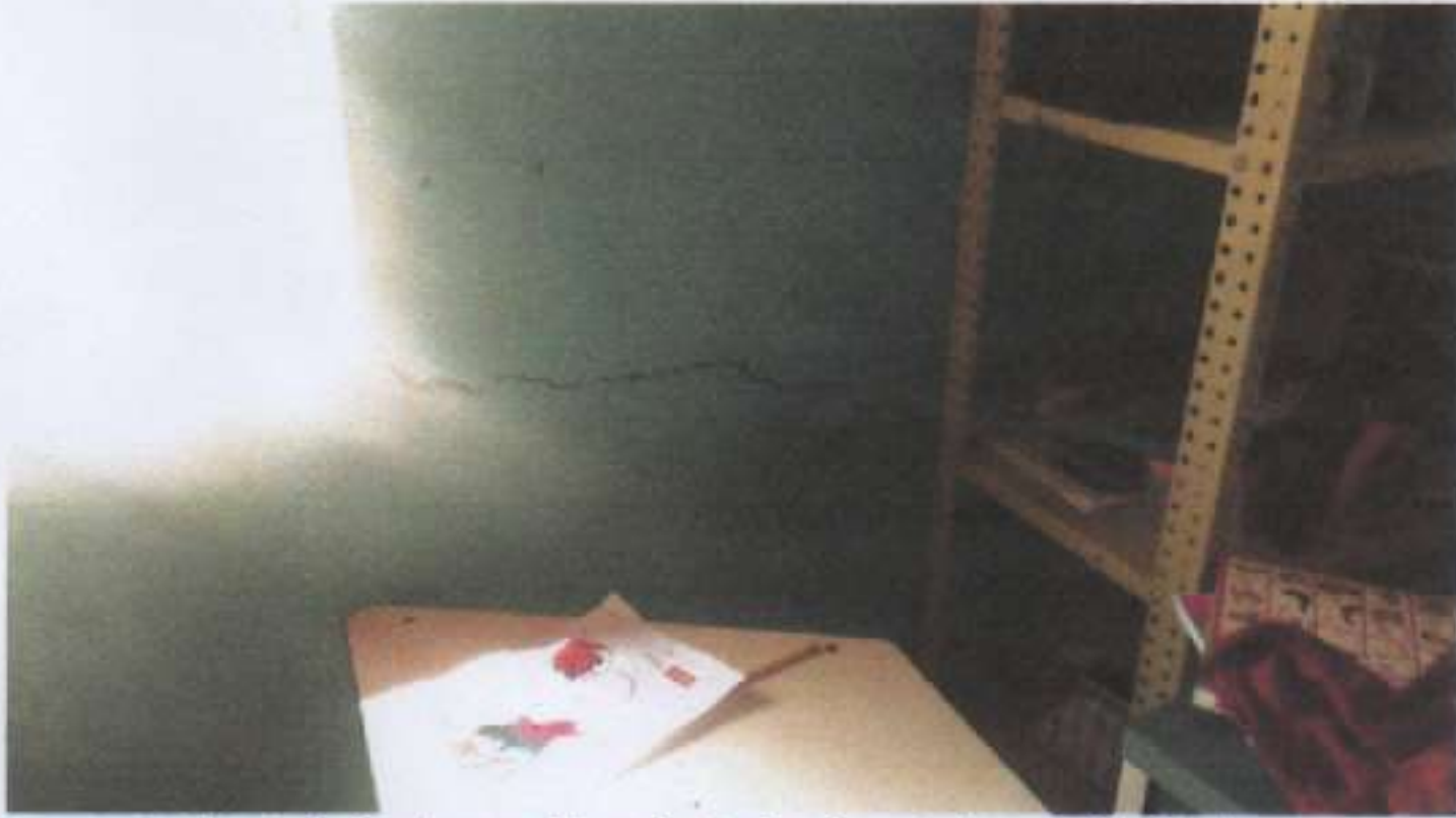
Figura 8. Fractura en Muro Posterior. Fuente: Inspección Ocular.
