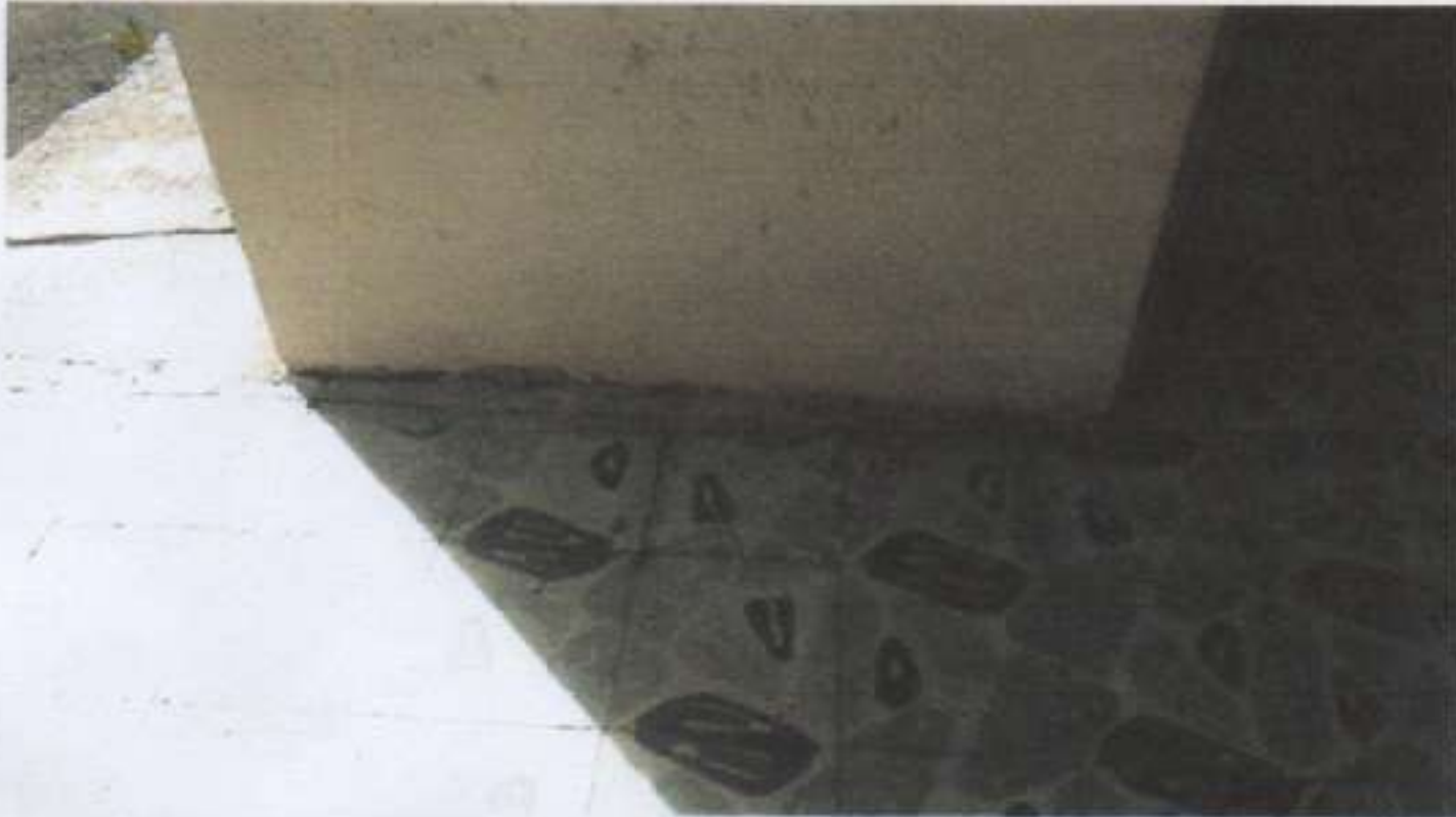
Figura 5. Grieta entre Placa de Piso y Cara Exterior de Muro. Fuente: Inspección Ocular.
