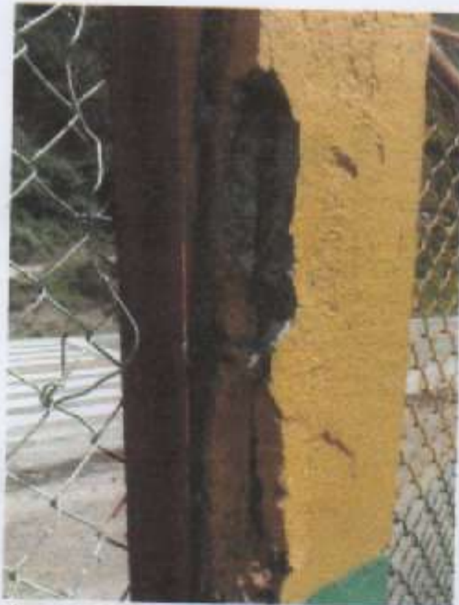
Figura 22. Desprendimiento de Material en Columna de Portón. Fuente: Inspección Ocular.
