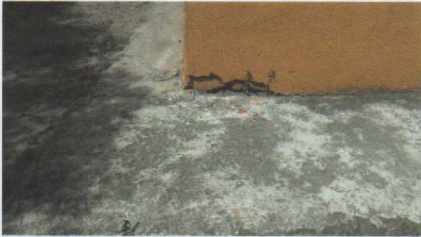
Figura 3. Grieta entre Placa de Piso y Esquina Exterior de Muros. Fuente: Inspección Ocular.
