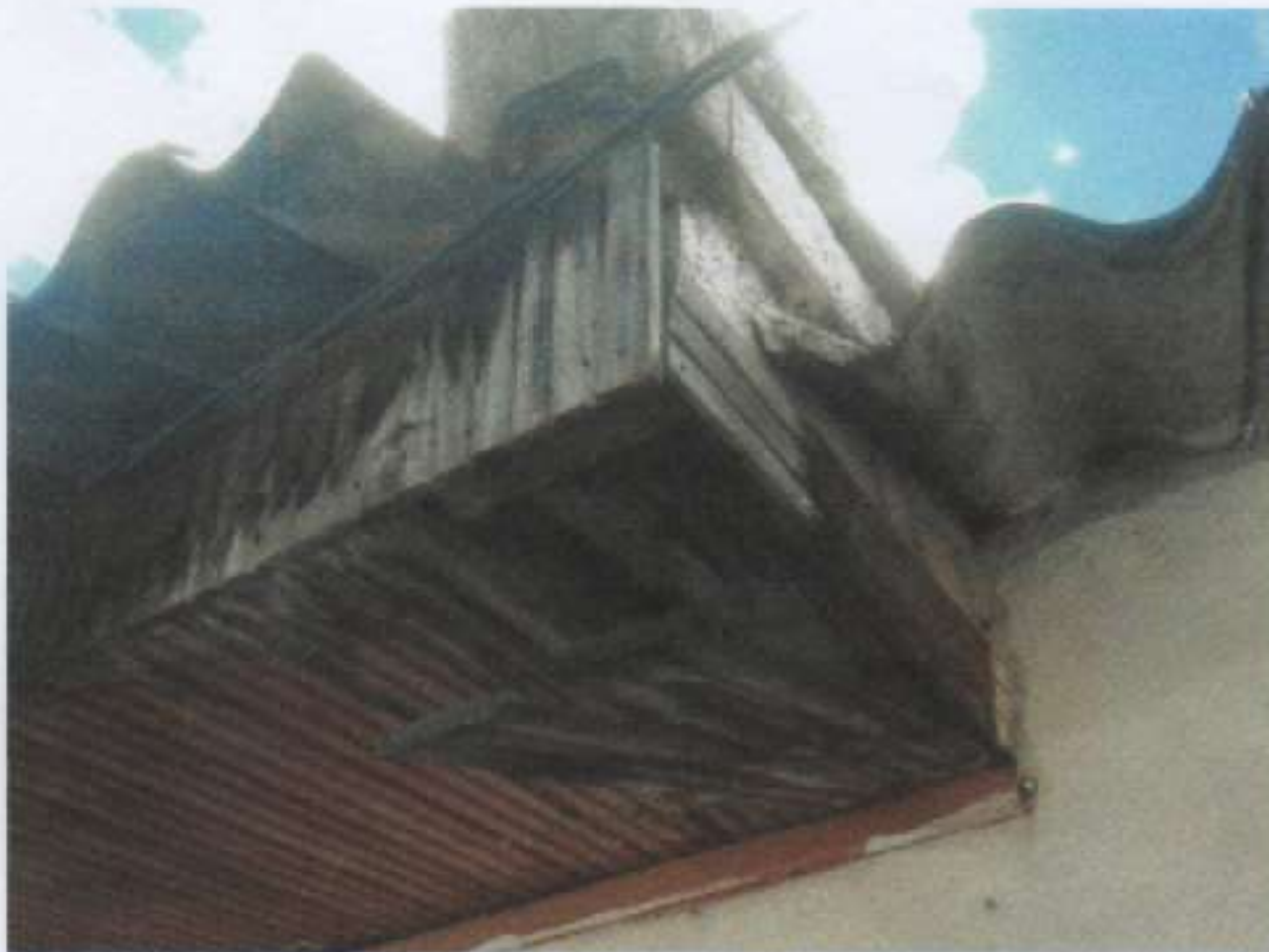
Figura 18. Afectación de Cielo Raso Exterior. Fuente: Inspección Ocular.
