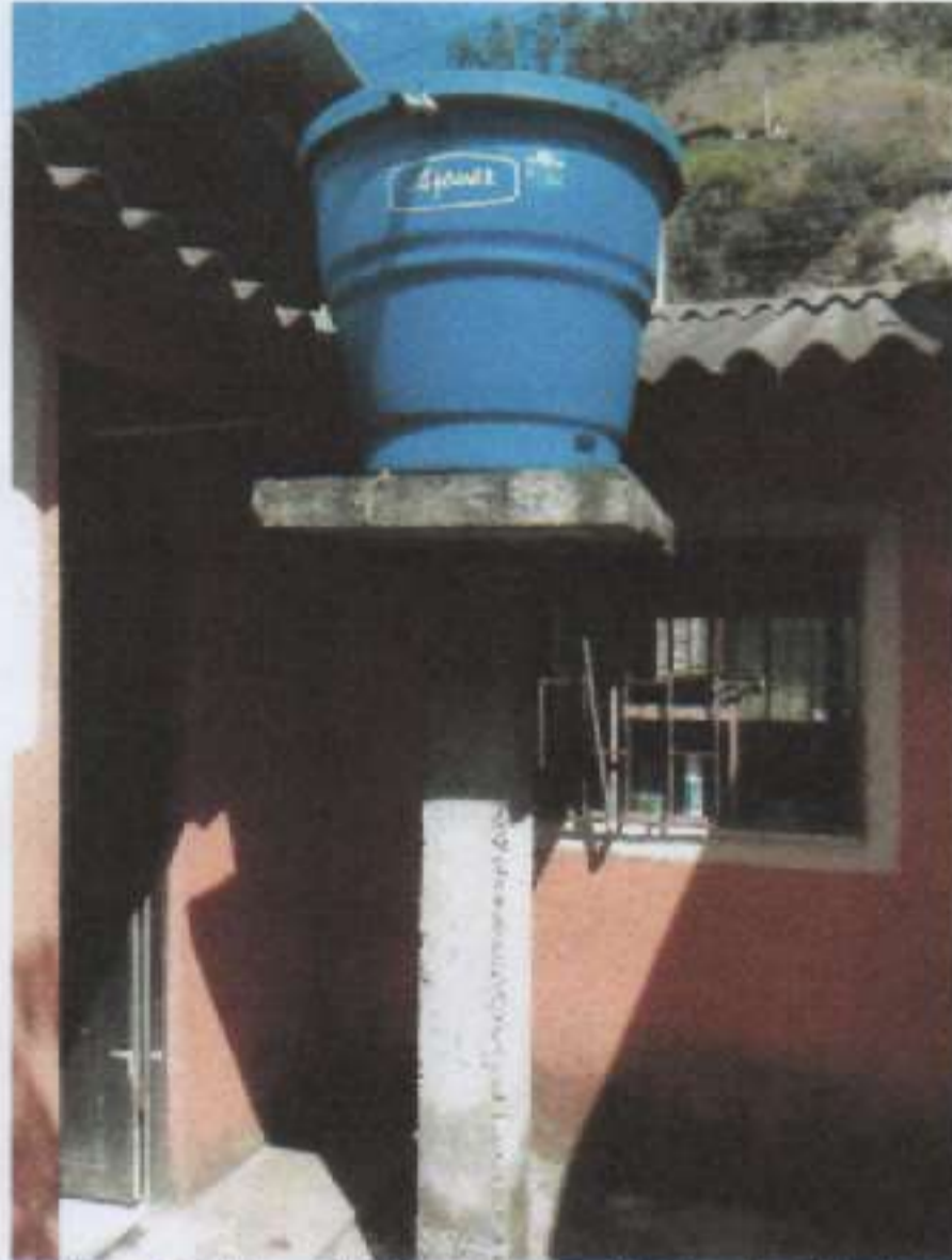
Figura 16. Humedad por Absorción desde el Suelo. Fuente: Inspección Ocular.
