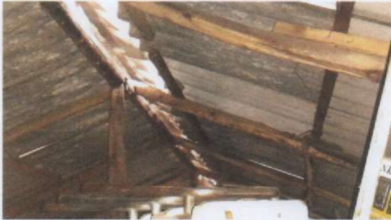
Figura 17. Afectación de Estructura Portante de Cubierta. Fuente: Inspección Ocular
