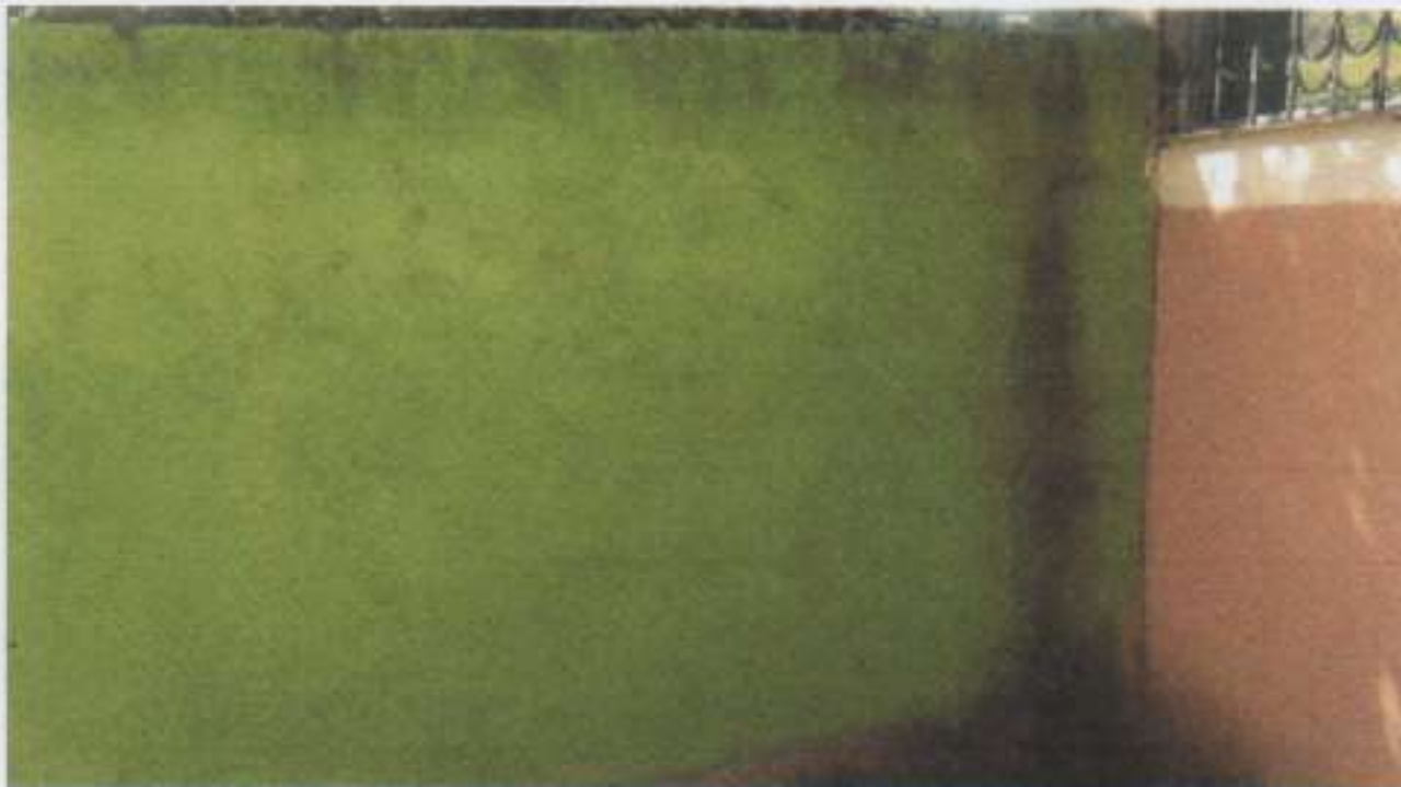
Figura 15. Humedad Exterior por Gravedad. Fuente: Inspección Ocular.
