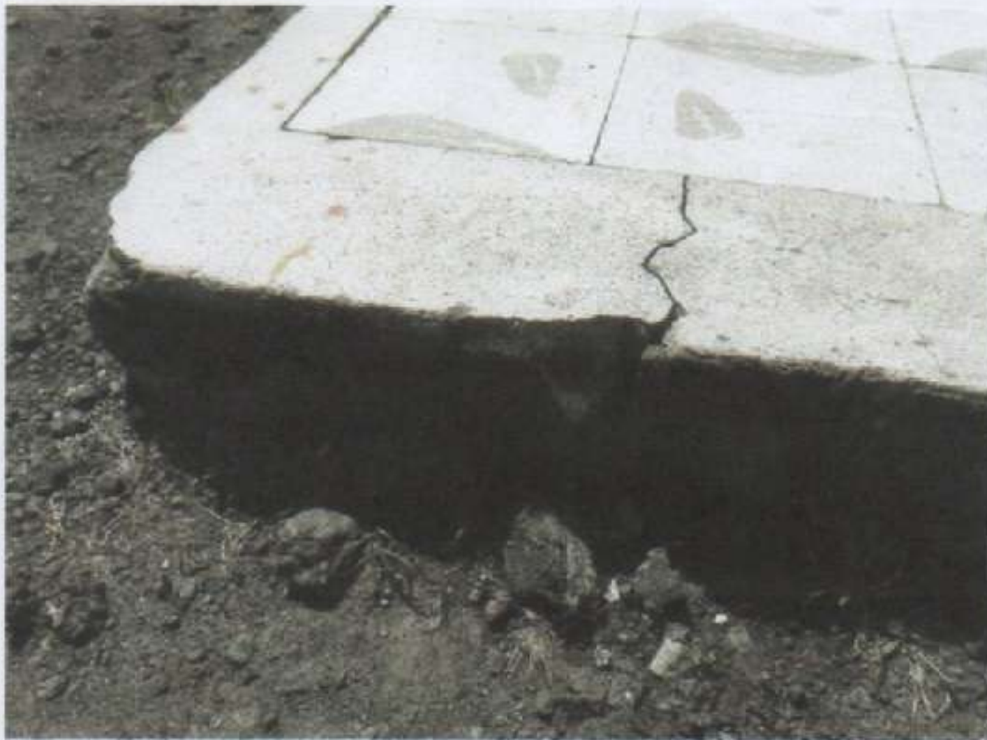
Figura 6. Fractura de Placa de Piso. Fuente: Inspección Ocular.
