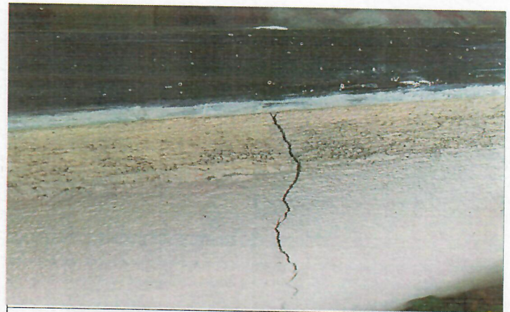
Propietario manifiesta fisuramiento en el muro lateral derecho de la habitación 1, debido a vibraciones generadas por el transito de volquetas, esta fisura se refleja en ambas caras del muro.
