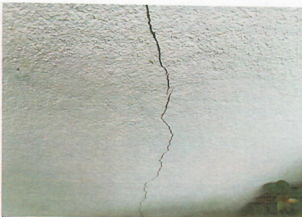
Propietario manifiesta fisuramiento en el muro lateral derecho de la habitación 1, debido a vibraciones generadas por el transito de volquetas, esta fisura se refleja en ambas caras del muro.
