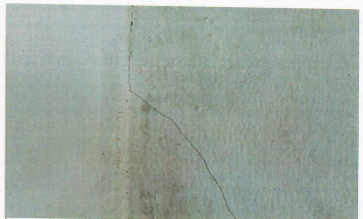
Propietario manifiesta fisuramiento en el muro lateral derecho de la cocina, debido a vibraciones generadas por el transito de volquetas, esta fisura se refleja en ambas caras del muro.
