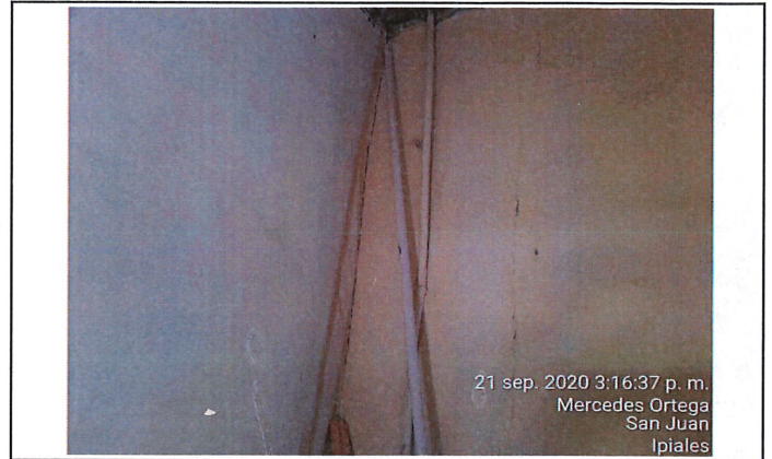
Habitacion 1 del segundo nivel de la vivienda: se observa separación de muros entre el posterior y el lateral izquierdo.
