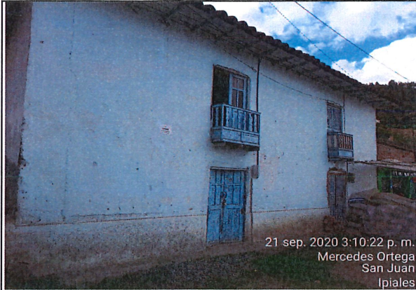
Vivienda de dos niveles con muros en tapia, presenta desgaste natural, sus acabados son en repello y pintura.
