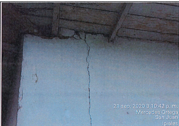
Fachada frontal de la vivienda: se observa fisura longitudinal con desprendimiento de acabados, esto es en el costado superior izquierdo.
