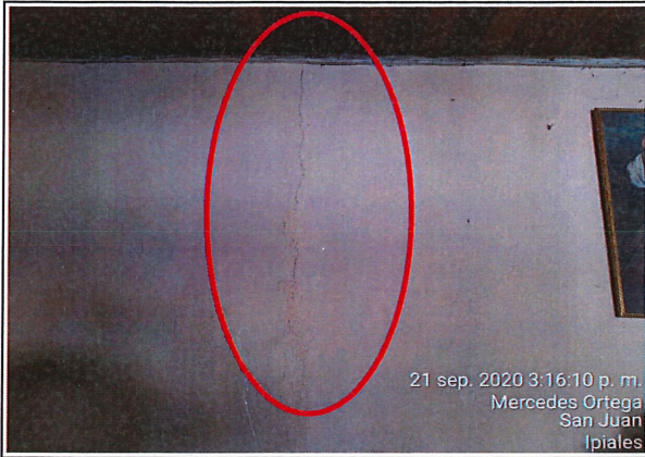
Habitacion 1 del segundo nivel de la vivienda: se observa fisuras de tipo superficial longitudinales en el muro frontal.
