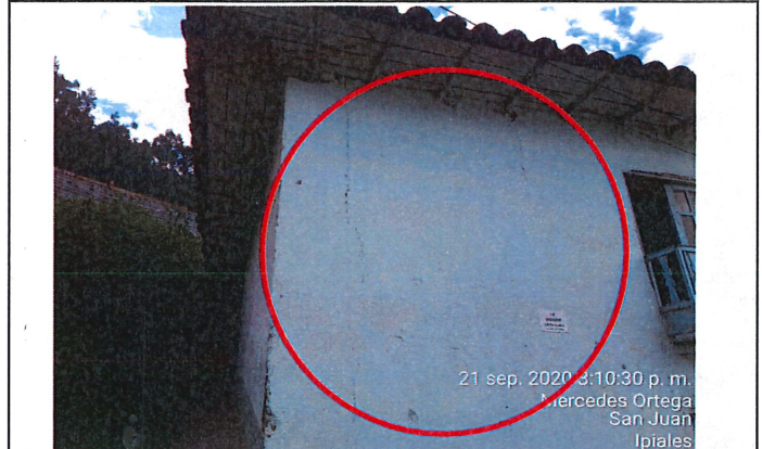
Fachada frontal de la vivienda: se evidencian múltiples fisuras de tipo superficial en el acabado, esto es en los acabados(repello y pintura)
