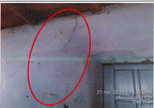
Fachada posterior de la vivienda: se observa múltiples fisuras en el costado lateral izquierdo de tipo superficiales en el acabado en repello y pintura.
