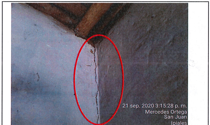
Fachada posterior de la vivienda: se observa una grieta en el costado derecho en la zona superior al marco de la puerta de madera que da ingreso a la habitación 1, así como múltiples fisuras en el costado lateral izquierdo de tipo superficiales en el acabado en repello y pintura.
