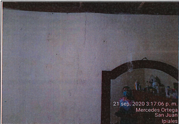
Habitacion 2: se observa grieta en muro lateral izquierdo de tipo longitudinal y en la esquina fisuras superficiales en repello y pintura.
