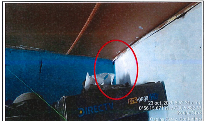
Habitación 1: se observa inicio de separación muros entre el lateral derecho y posterior, así como el lateral izquierdo y posterior.
