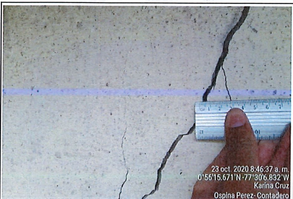
Fachada posterior de la vivienda: se observa múltiples grietas y fisuras con variaciones (las grietas han aumentado de espesor 5mm), los acabados son en repello y pintura
