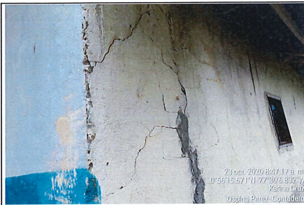
Fachada posterior: agrietamiento en costado izquierdo zona inferior
