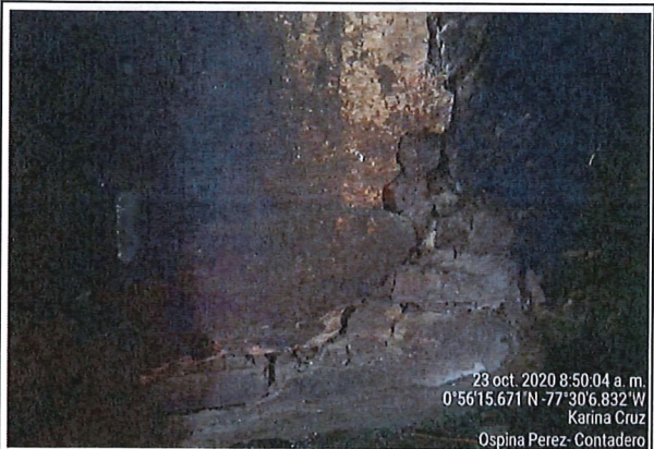
Cocina: se observa múltiples grietas avanzadas con variaciones tanto en muro frontal como posterior, se observa separación de muros, zona de alto riesgo.
