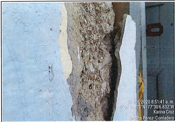
Fachada lateral derecha: se observa desprendimiento de acabados (repello y pintura)
