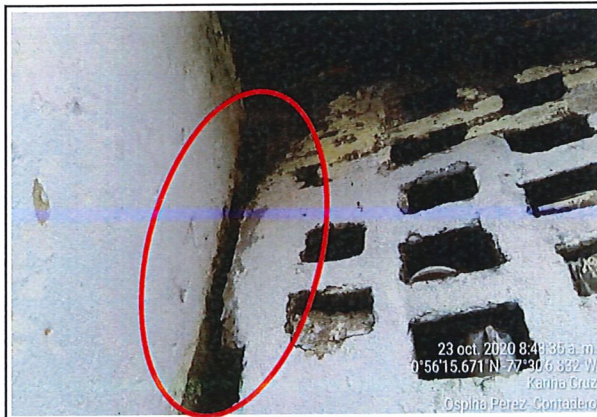
Fachada lateral derecha: identificación de separación de muro frontal de la cocina con muros de habitación 1
