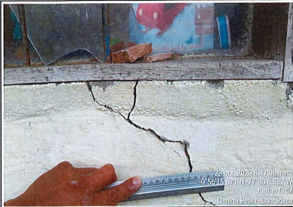
Fachada posterior: se evidencia múltiples grietas en zona inferior a ventana, el espesor es de 3mm
