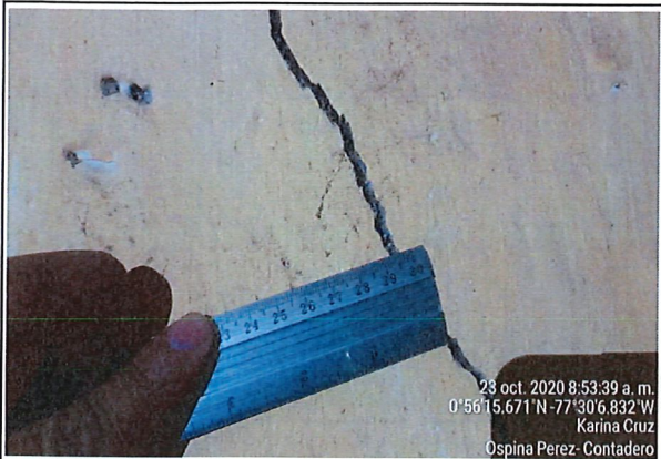
Habitacion 2: se observa grietas en muro posterior de 4 mm de espesor longitudinales, también en el lateral izquierdo así como frontal.
