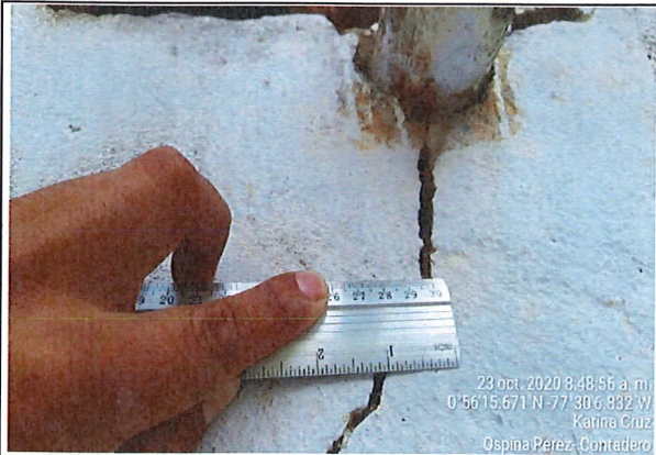
Grieta de 5 milímetros de espesor en fachada de cocina.
