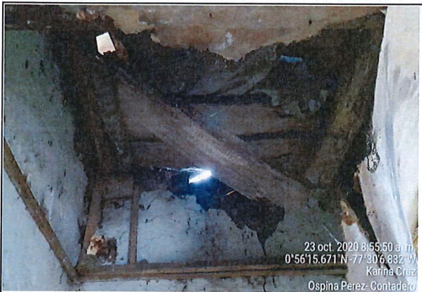
Bodega 1: se observa grieta en muro lateral derecho de tipo longitudinal y transversal, así como colapso de cielo raso en tríplex
