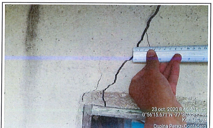
Fachada posterior de la vivienda: se observa múltiples grietas y fisuras con variaciones (las grietas han aumentado de espesor 5mm), los acabados son en repello y pintura
