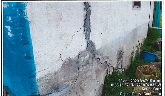
Fachada posterior: agrietamiento en costado izquierdo zona inferior
