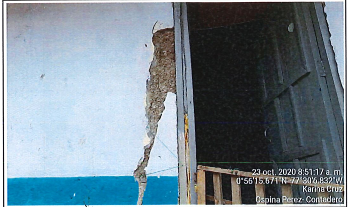
Fachada lateral derecha: se observa desprendimiento de acabados (repello y pintura)
