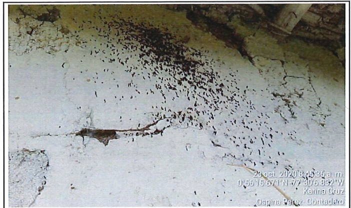
Fachada lateral izquierda: se observa múltiples fisuras y grietas longitudinales y transversales con desprendimiento de acabados.
