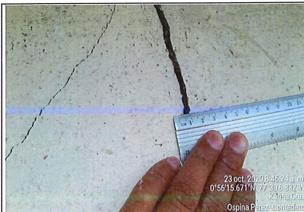
Fachada lateral izquierda: se observa múltiples fisuras y grietas longitudinales y transversales con desprendimiento de acabados.
