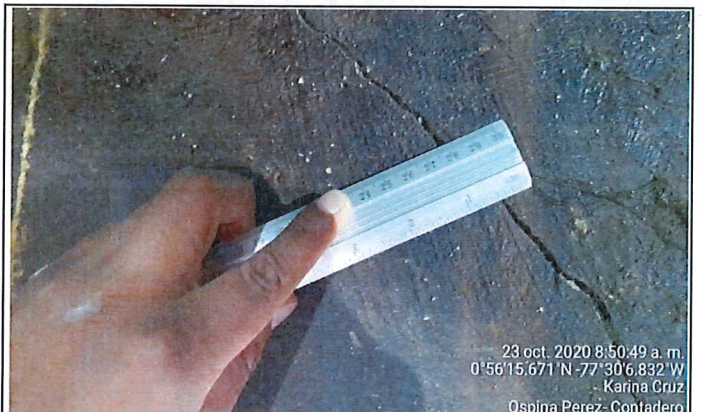
Cocina: se observa múltiples grietas avanzadas con variaciones tanto en muro frontal como posterior, se observa separación de muros, zona de alto riesgo.
