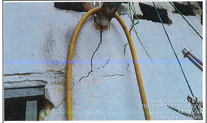
Fachada lateral derecha: se observa en el costado lateral derecho en la zona de la cocina múltiples grietas y fisuras en muro, la zona superior cuneta con separación de muro las cuales han tenido variaciones.
