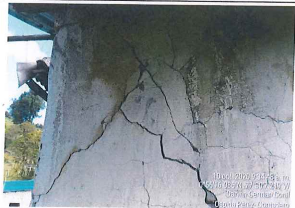
Múltiples fisuras en muro lateral derecho parte superior (cocina)
