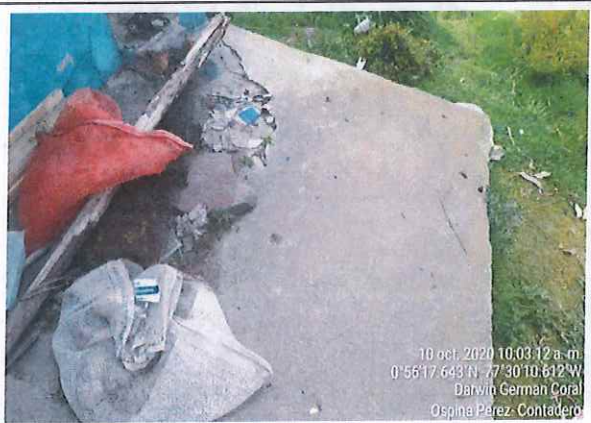
Grieta en piso de cocina
