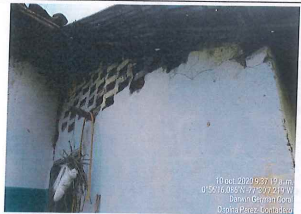
Separación entre muro de habitación y cocina
