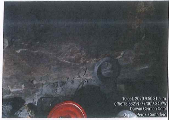
Fisuras en muro de cocina
