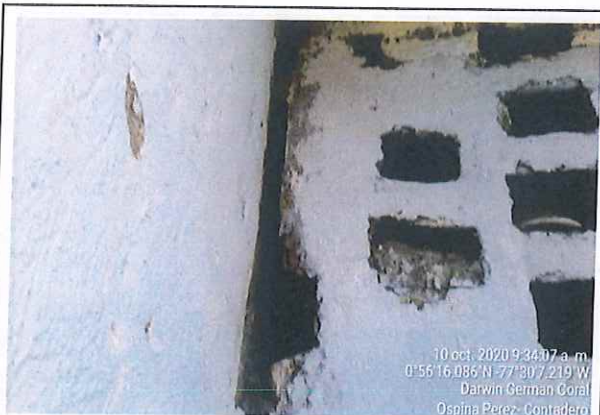
Separación entre muro de habitación y cocina
