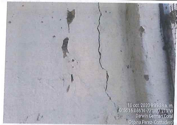
Grieta en muro lateral derecho de fachada
