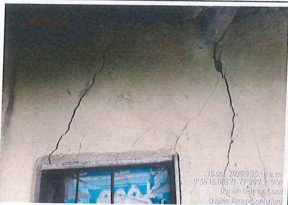
Múltiples grietas y fisuras en muro lateral de fachada (cocina)
