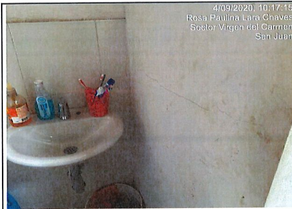
Fisura transversal en zona de lavamanos
