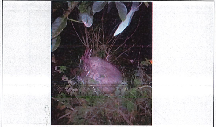
Se realiza visita en la cual el propietario manifiesta que en el mes de julio de 2020 se genero un deslizamiento de rocas provenientes del CO-157 la cuales impactaron un tanque plástico y batería sanitaria que no estaba instalada.
