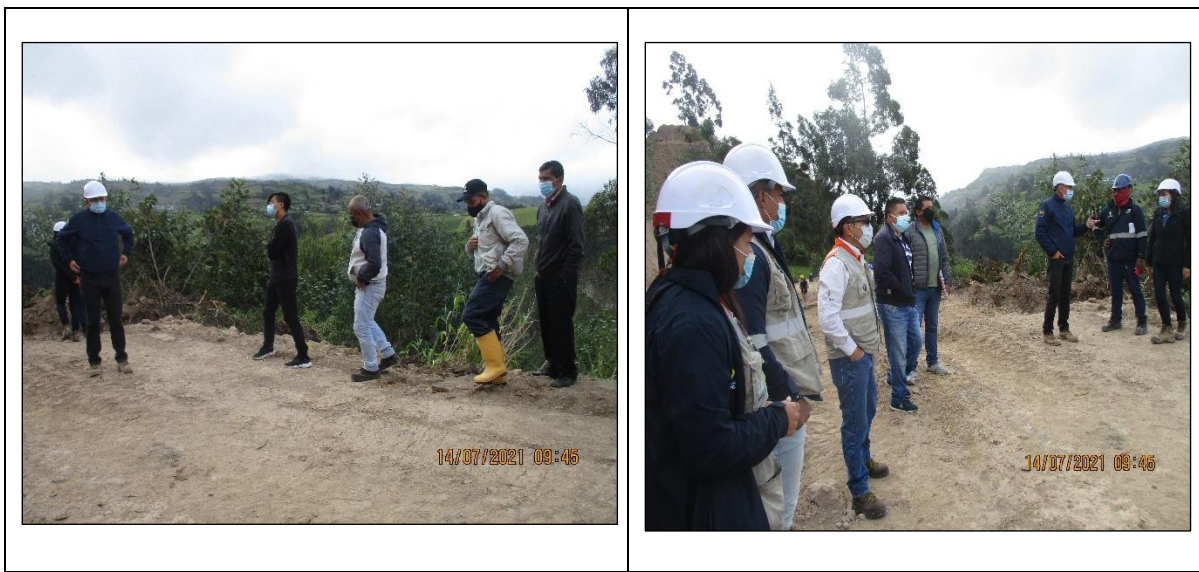
El directo técnico del Consorcio SH Ing. Juan Espinoza, el jefe del tramo UF 1.3 Ing. Hernán Estrella socializaron las actividades constructivas que se están ejecutando en la parte alta del corte 163.
