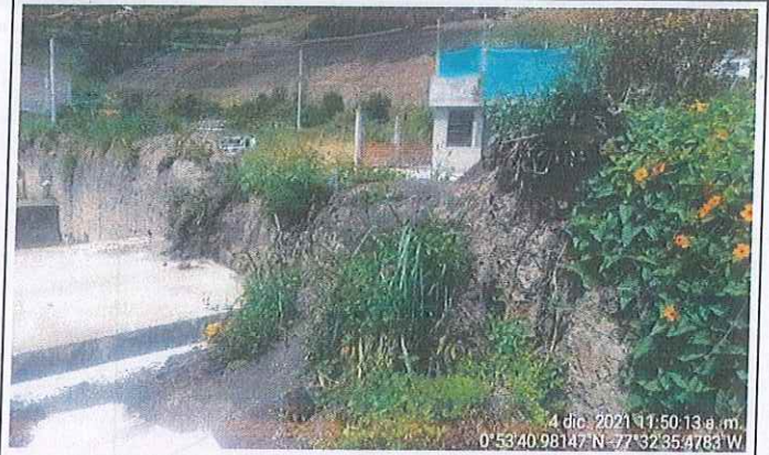
Zona frontal de muro de cerramiento: se refiere desplome de 8m lineales de muro en tapia ubicado en sección izquierda a causa de transito de maquinaria pesada y volquetas
