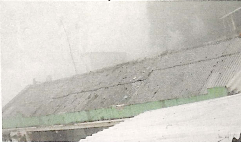
Techo fisurado y corrido de la vivienda
