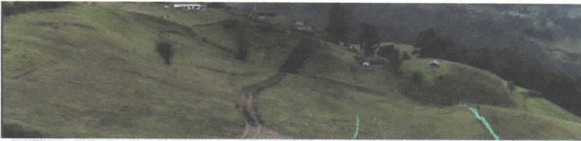
Inicio de actividades de obra donde no se evidencia ningún acceso vehicular.
