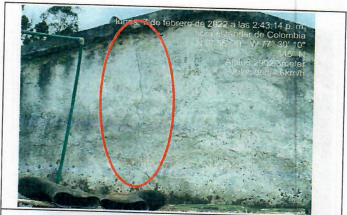
Fachada lateral izquierda: se refiere fisura de tipo longitudinal
