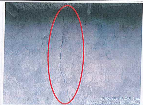
Fachada lateral izquierda: detalle de fisuramiento ubicado en sección central y de tipo longitudinal
