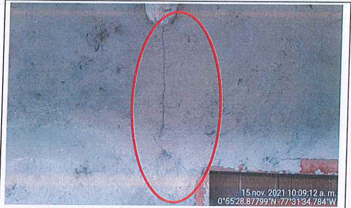
Fachada frontal: fisuramiento preexistente de tipo transversal ubicado en la sección central, se desprende desde cubierta hasta parte superior de marco de puerta
