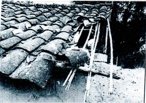
Propietario desplome parcial de la cubierta, debido al golpe de una roca desplazada de obras de corte en el sector.
