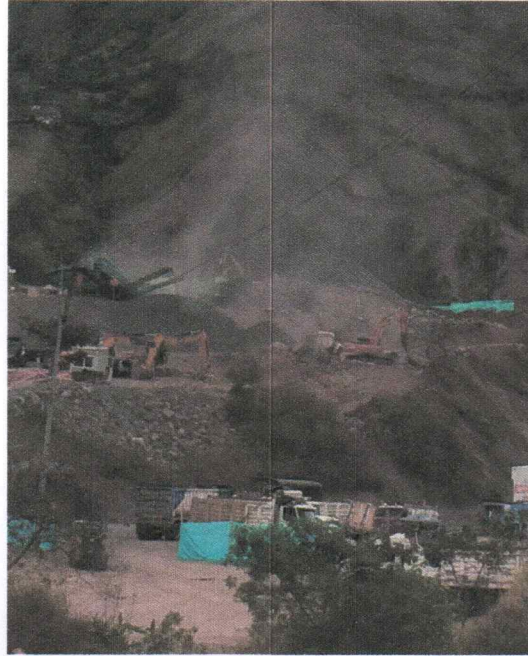
Vista Diurna de La Planta de extracción y explotación de materiales de construcción sector El Capulí, frente al centro recreacional "Sol Caribe" foco de contaminación 1
