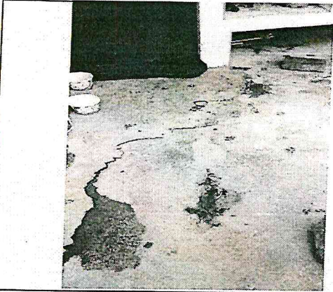
Desprendimiento del material superficial en el patio de terraza ubicado en el cuarto piso. Esta afectación también persiste.
