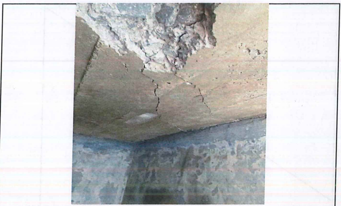
En la parte interna la losa se observa con múltiples roturas y con desprendimiento del material superficial.
