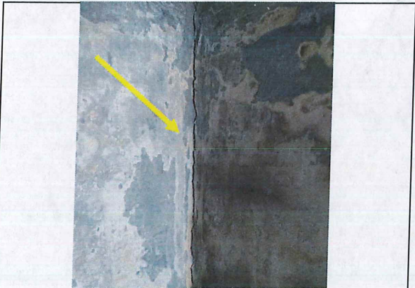
Grieta ubicada en una de las uniones de los muros en la parte interna.
