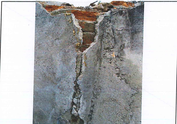
Las esquinas exteriores del tanque de almacenamiento de agua se encuentran afectados, donde se les observa grietas y desprendimiento del material superficial.
