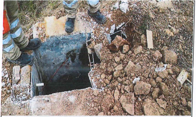
La losa superior se observa fracturada por el impacto de la volqueta, además se observa desprendimiento del materia superficial y la tapa de inspección no se encuentra en el sitio.
