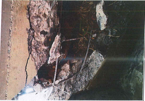
Estado actual de la losa superior del tanque de almacenamiento de agua.
