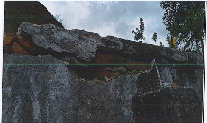
En la parte superior de todos los muros se observan con grietas y desprendimiento del material superficial.
