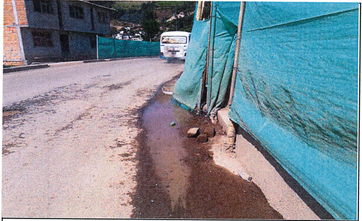
Propietaria manifiesta afectaciones en el acceso de su predio debido al represamiento de agua por sedimentación en la cuneta.
