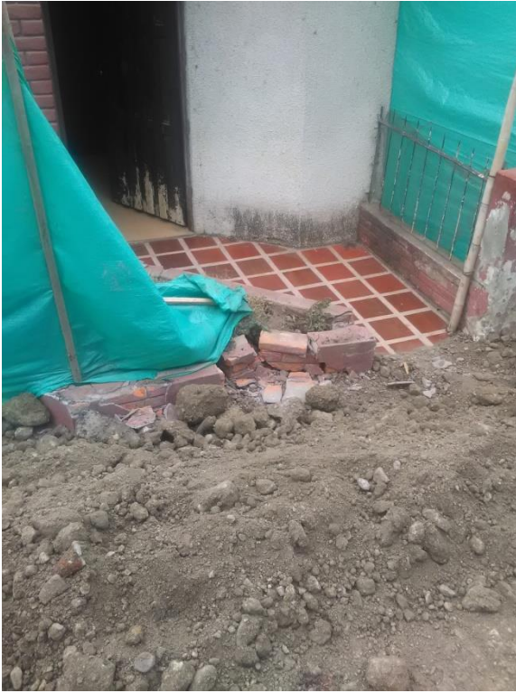
Daños en la entrada de la casa.
