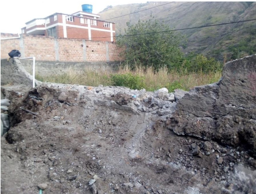
Derrumbe del muro de cerramiento del lote, es el mismo propietario de la casa.
