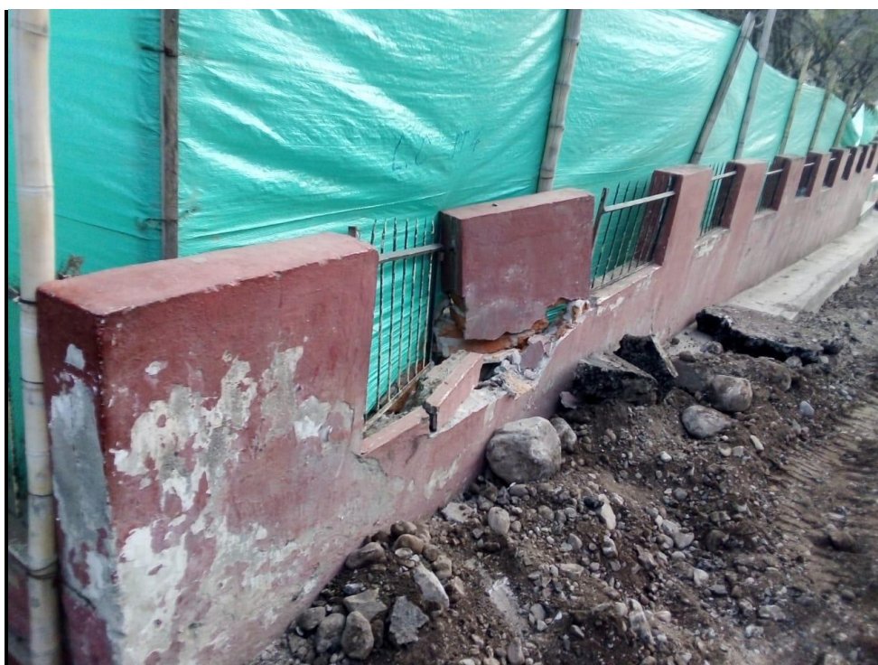
Daños en el antepecho del antejardín y en la reja de este.
