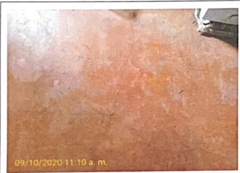
FOTO 3. Múltiples fisuras en piso de concreto con acabado en mineral rojo.
