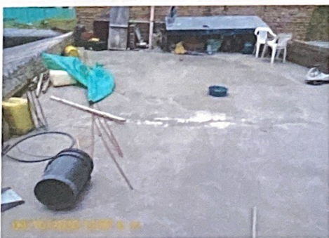
FOTO 11. Piso de terraza con desprendimiento de material y deterioro natural.
