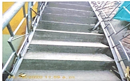
FOTO 10. Gradas en concreto con deterioro natural.
