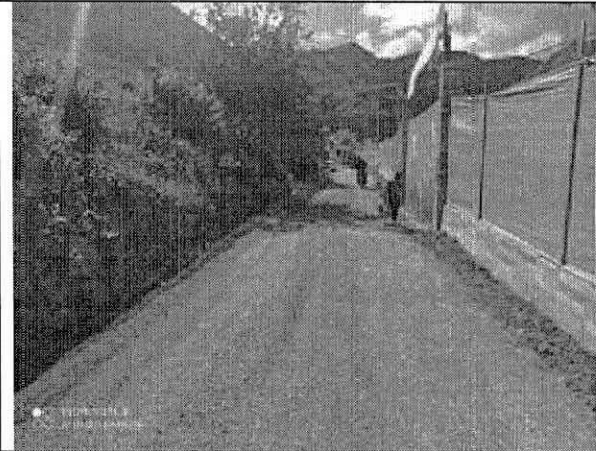
Fecha: 14/01/2021 Descripción: implementación medidas de manejo, limpieza de cunetas y protección de vía, material de recebo, sector El Porvenir
