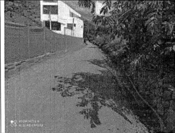
Fecha: 14/01/2021 Descripción: implementación medidas de manejo, limpieza de cunetas y protección de vía, material de recebo, sector El Porvenir
