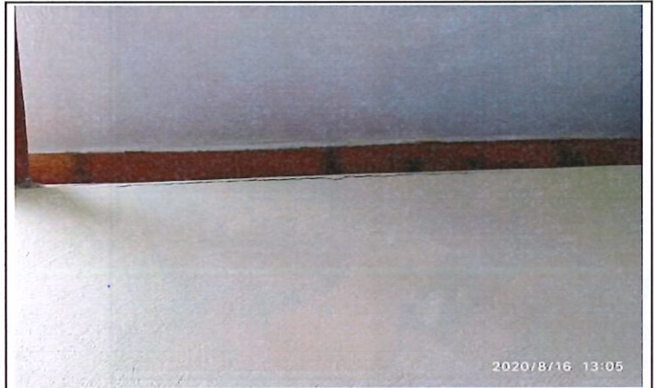
Fisura entre cielo raso y muro de baño privado en habitación 2
