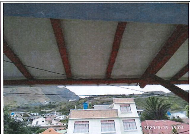
Balcón, se indica fisuras en cielo raso las cuales son de tipo pre existente
