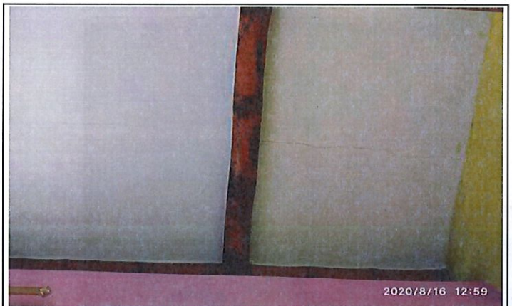
Fisuras en cielo raso de hall
