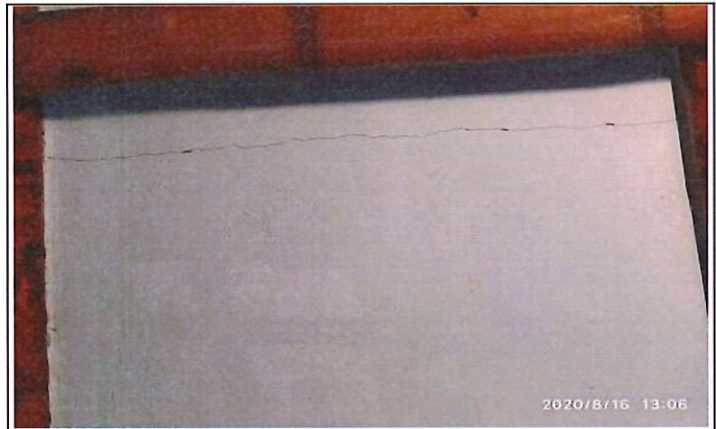
Fisura en cielo raso de habitación 3 en segundo nivel
