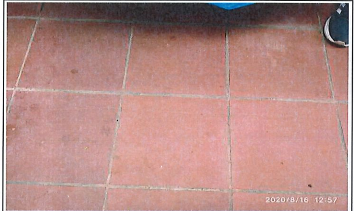
Fisura en piso de patio de ropas, el cual cuenta con enchape en tableta de gres
