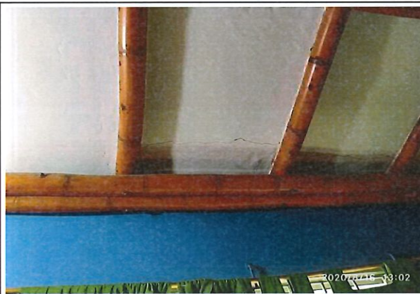
Fisuras en cielo raso de habitación 2 en segundo nivel
