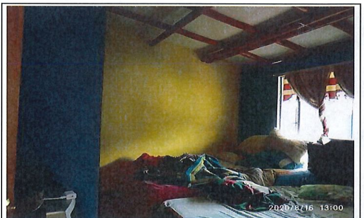
Habitación 1 de segundo nivel, presenta fisuras en cielo raso
