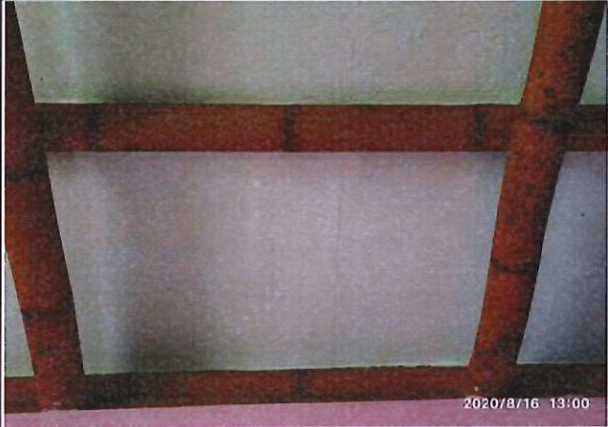
Fisuras en cielo raso de habitación 1 en segundo nivel
