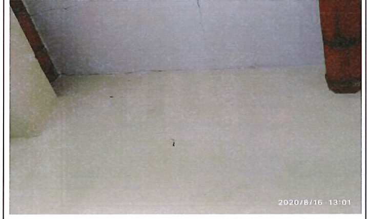
Fisuras en cielo raso de baño 1
