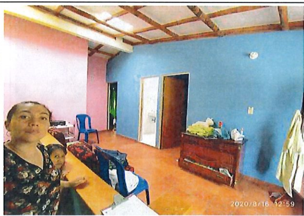
Hall en segundo nivel, se presenta múltiples fisuras en cielo raso
