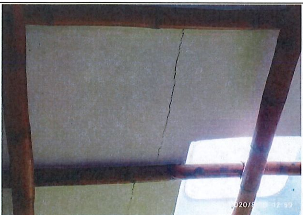
Fisuras en cielo raso de hall, estas son de tipo pre existente
